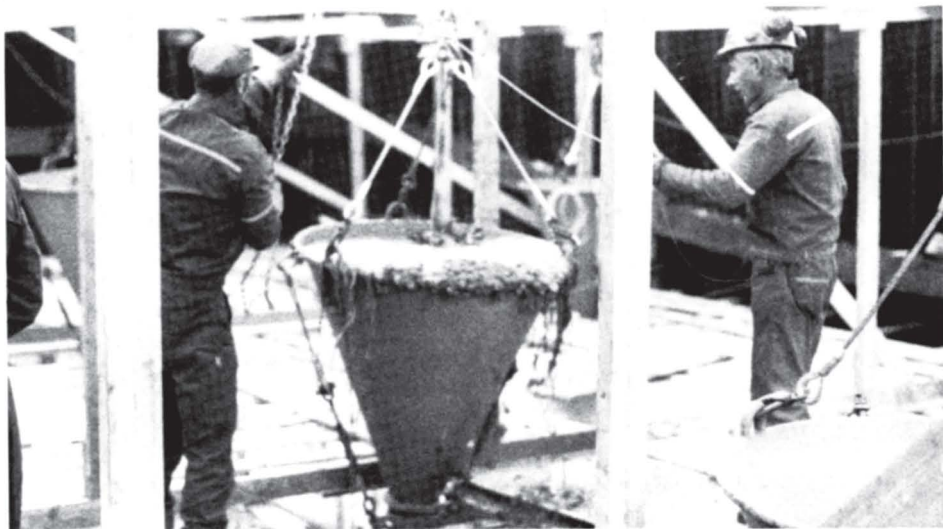
En av de tolv støpetraktene.
