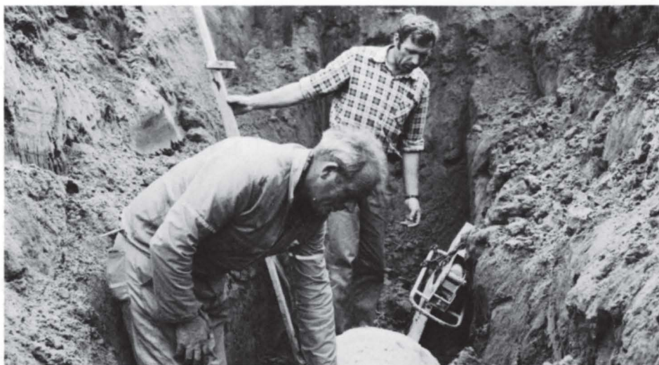
Sigurd Rismyr (foran) og Arnfinn Solberg i ferd med å legge ned rør.
