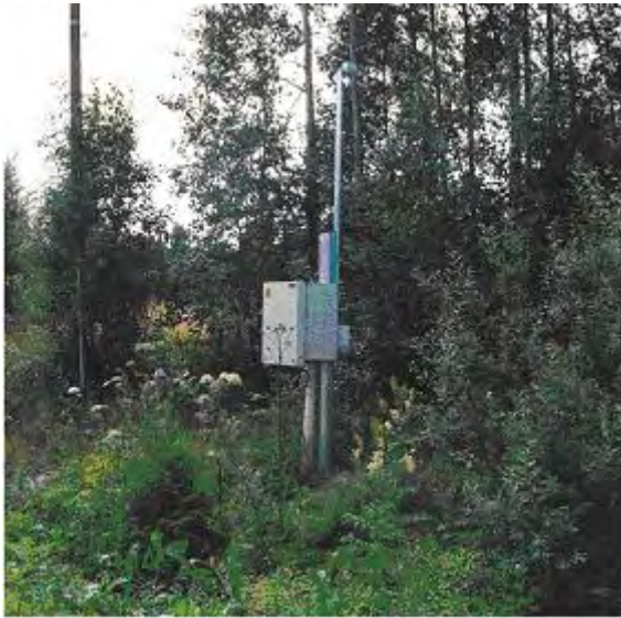
Figur 4. Klimastasjon der det ikke er foretatt nødvendig rydding av kratt og busker.
