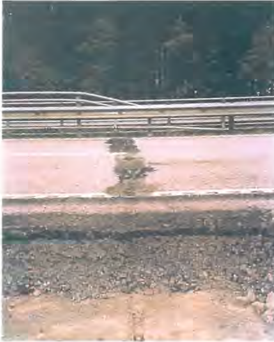
Figur 32. Sprekk i overgang mellom avlastningsplate og betongplate over EPS laget
