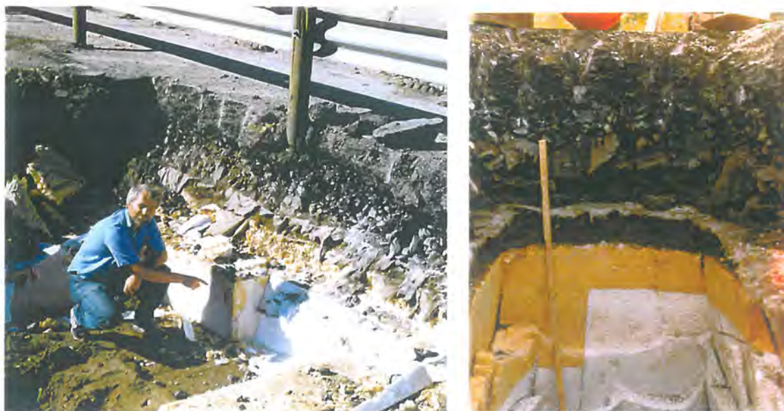
Figur 15. Utgraving av EPS blokker etter inntil 20 år i marken.
