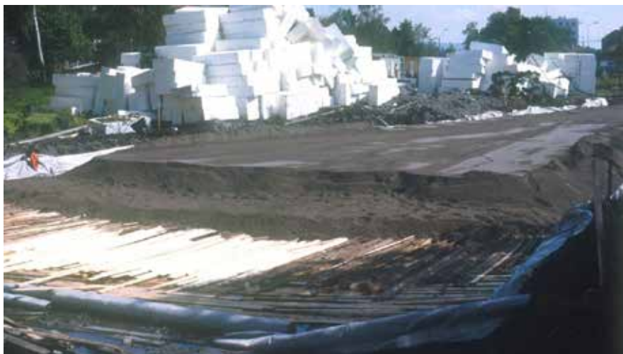
Figur 1-4- 1 Bruk av bakhon som armering under fylling i Fornebukrysset (Foto: Roald Aabøe)
