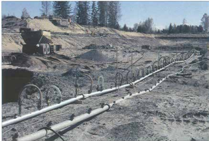
Figur 1-9-1 Anlegg for grunnvannssenking
