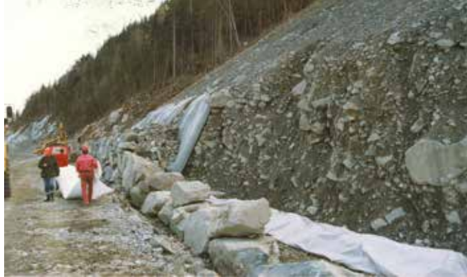
Figur 3-2- 8 Tinnssjøvegen, Telemark. Erosjonssikring av skjæring i ur med fiberduk før permanent sikring med tørrmur. (Foto: Emil Gyøry, Telemark).
