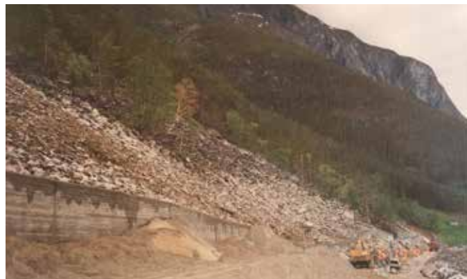
Figur 3-2- 9 Plasstøpt betongmur på fjellfot som sikring på Rv. 53 Naddvik – Fornes, Sogn og Fjordane. Stabilisering av ura på oversiden av mur med ordnet steinfylling (Foto: E. Husabø).
