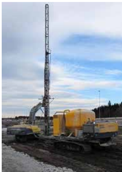
Figur 1-7-1 Rigg som setter kalksementpeler for E18 i Vestfold (Foto Bjørn Kristoffer Dolva)
