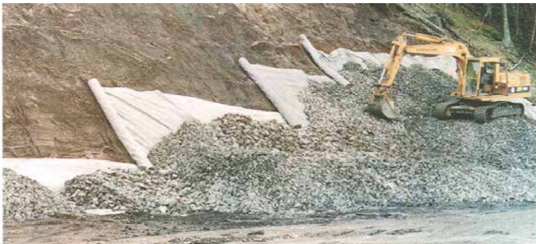
Figur 2-3-1 Dersom grunnen består av erosjonsømfintlige materialer (silt - sand) kan det være nødvendig å sikre grunnen mot erosjon med lag av grov grus/pukk på fiberduk for å hindre utvasking av masser fra skråningen inn i fyllingen. (Foto: Nils Rygg, Veglaboratoriet).
