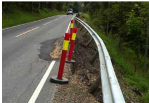
Figur 1-4-26 Ustabil skråning på fv. 111 i Trøgstad (Foto Jan Vaslestad)
