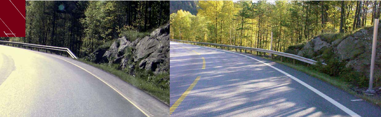
Eksempler på rekkverksavslutning før og etter utbedring
