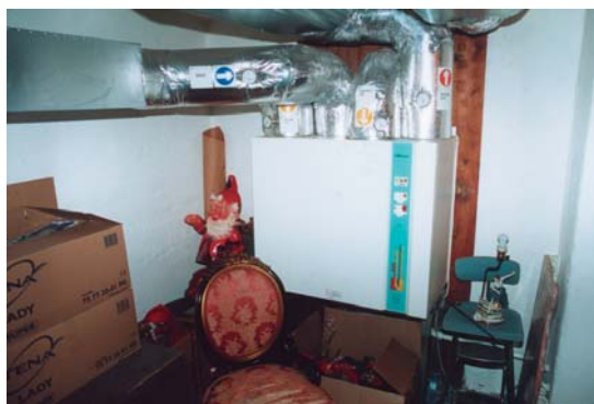
Aggregat for enebolig plassert i kjeller. LM
