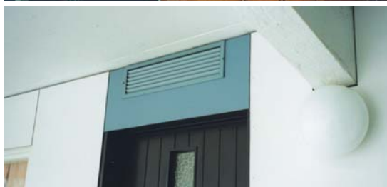
Utvendig rist for luftinntaket er integrert i feltet over inngangsdøren. LM
