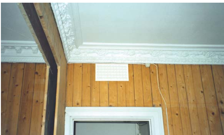
Ved plassering av tilluftsventilen er det tatt hensyn til gipsstukkaturen i overgangen mellom vegg og tak. LM
