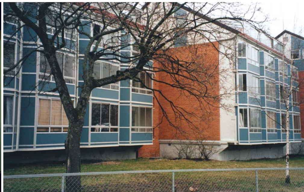
Støyskjermene i området har ikke effekt for balkongene. Ved å skjermes uteplassen på balkongene med nye fasadelementer i glass og plateledning, oppnådde man samtidig tilstrekkelig demping av innendørs støynivå uten ytterligere tiltak på vegger og vinduer. Det er lagt betydelig vekt på utforming og detaljering av de nye bygningselementene som inngår i fasaden på en naturlig måte. LM
