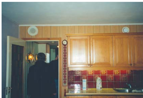
Aggregat for en branncelle montert i leilighet. Selve aggregatet er montert på vegg, og er et dominerende element i en trang gang. I tillegg blir lydnivået direkte fra aggregatet for høyt ved dimensjonerende luftmengde. LM
