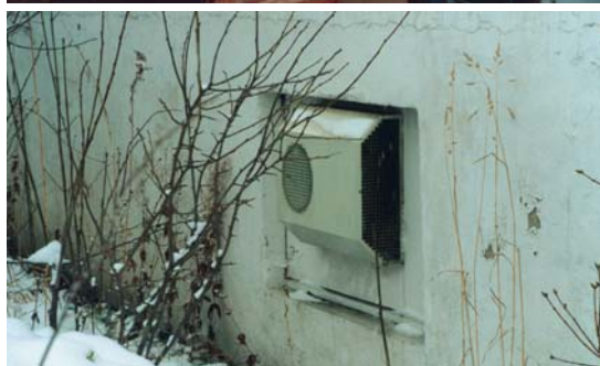
Kombiventil benyttet til avkastluft montert i gjentettet kjellervindu. LM
