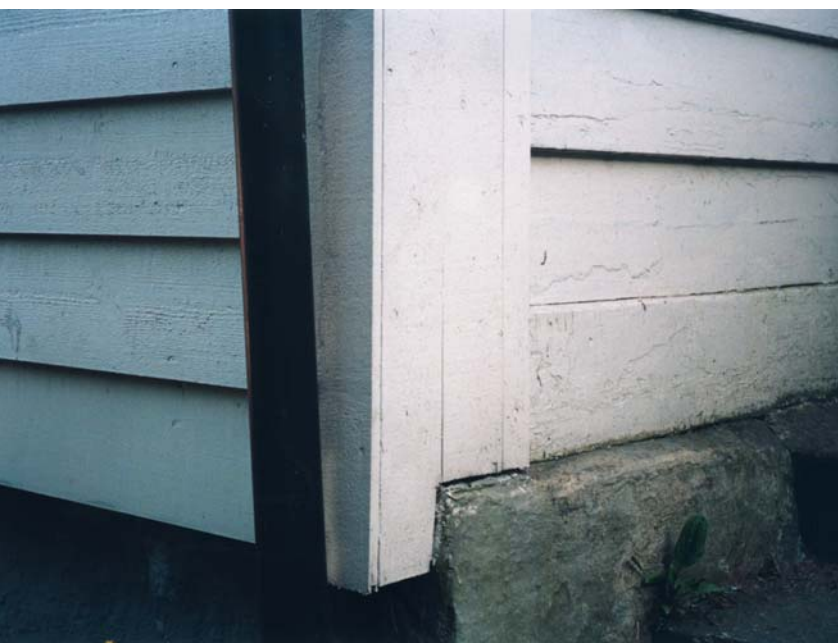
Det gamle panelet av høvlet virke på veggen til høyre er tykkere og bredere enn det nye, uhøvlede som er satt på veggen til venstre.
