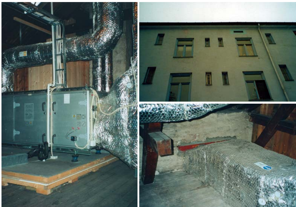
Ventilasjonsanlegg på loftet i en bygård. Aggregatet er plassert på et vibrasjonsdempende fundament.
