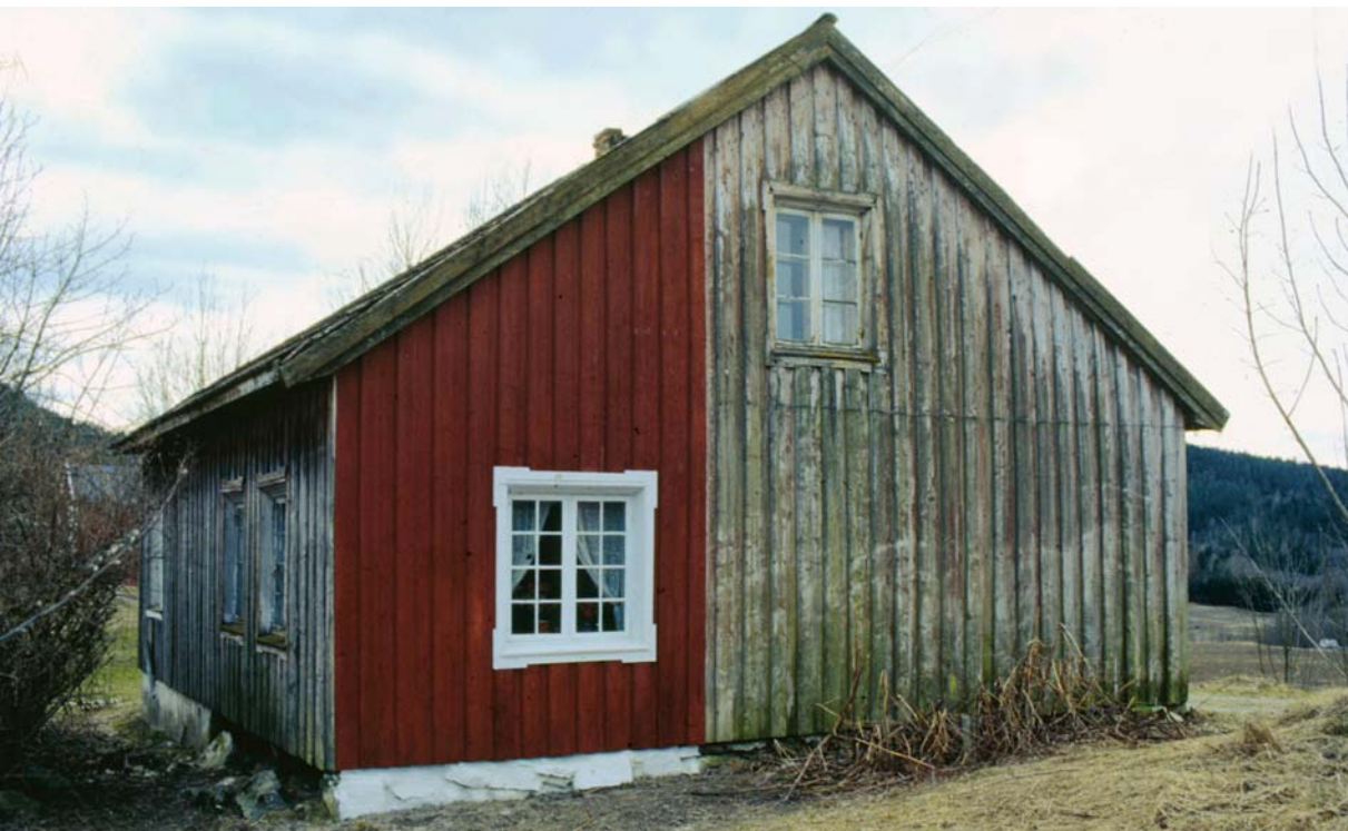
Panel og overflater som tilsynelatende har store fukt- og råteskader, trenger ofte bare forarbeid og maling. Veggen på bygningen er rengjort og påført et strøk komposisjonsmaling. Vinduene har fått ett strøk linoljemaling. FC
