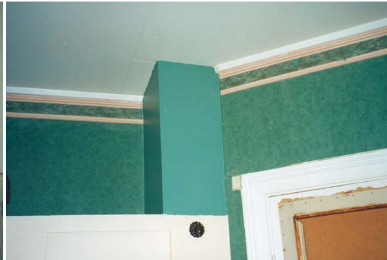
Kanalen er ført rett opp i taket og «kolliderer» med listverket. LM
