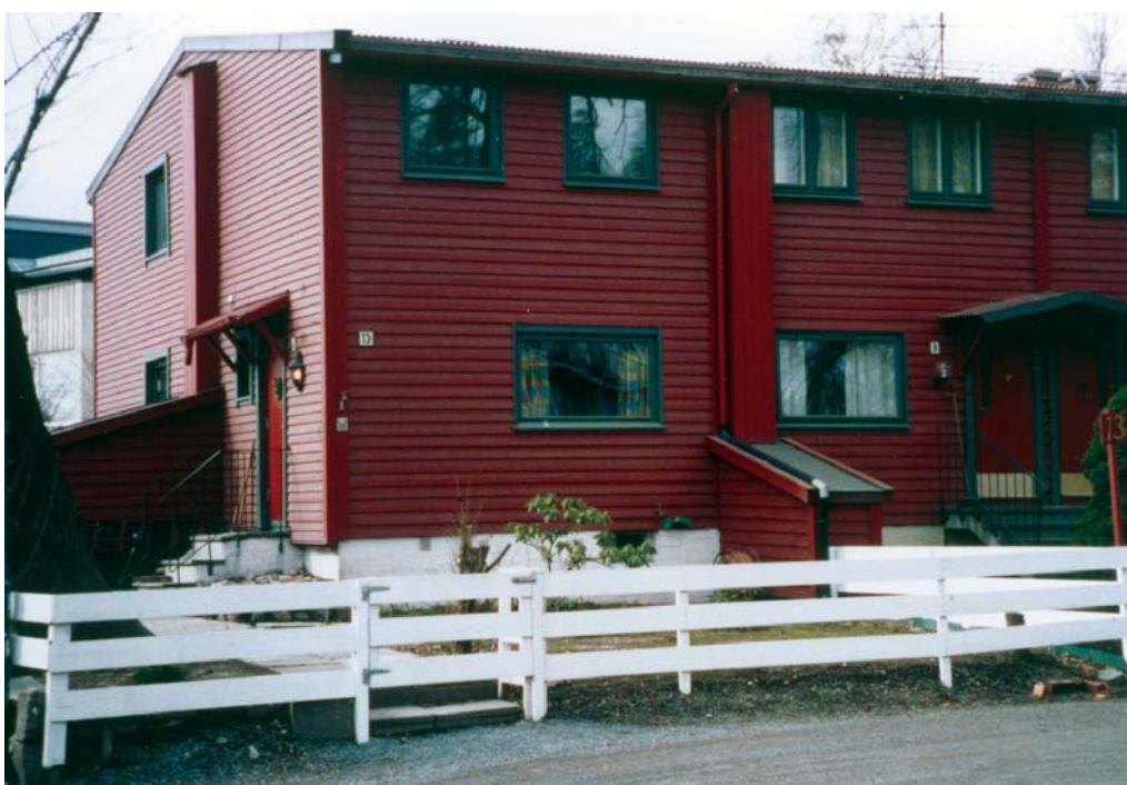
Det er foretatt flere fasadeendringer på dette rekkehuset: Bygningen er etterisolert utvendig. Installasjon av ventilasjonsanlegg medfører utvendige innkassede ventilasjonskanaler samt små tilbygg i første etasje som huser aggregatene. De opprinnelige to-fags sidehengslede vinduene er i noen av boenhetene erstattet med ett-fags husmorvindu. LM
