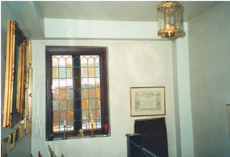
Ny ventilasjonskanal løper langs taket og ned langs høyre hjørne i dette rommet. LM
