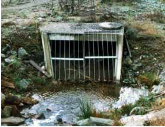
Figur 5-67: Rist ved innløpet til en kultvert. (Foto: V. Meland).
