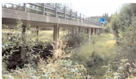
Figur 5-25: E6 er lagt på to bruer rett nord for Nebbenes i Eidsvoll kommune. Brua til venstre gjør det mulig for hjortevilt å passere under, selv om høyden er noe lav i vintre med mye snø. Deler av den andre bru er plassert så lavt over terrenget at store dyr bare unntaksvis passer under den. (Foto: V. Meland)
