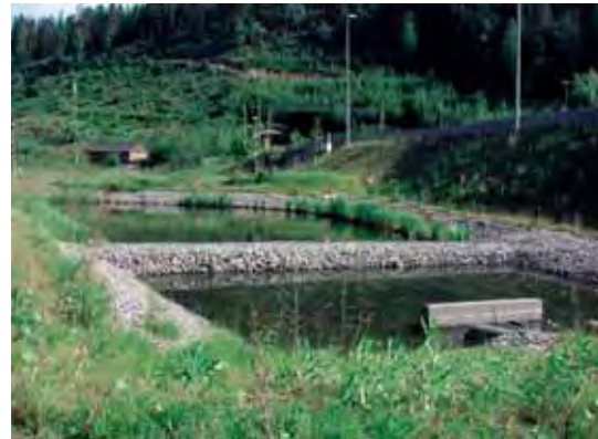
Figur 2-11: Sedimenteringsbasseng ved Nordbyntunnelen E6, Vassum, Akershus. (Foto: B. Iuell)
