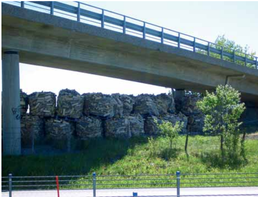
Figur 5-34: Her fungerer området under brua dårlig som faunapassasje siden det brukes som vedlager. Ved rutinemessig inspeksjon kan man sikre at slikt ikke skjer. (Foto: V. Meland)
