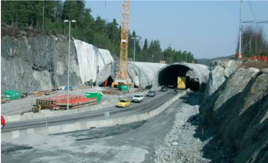
Figur 5-6: Faunaovergang på E6 i Ski kommune under bygging våren 2004. (Foto: B. Iuell)
