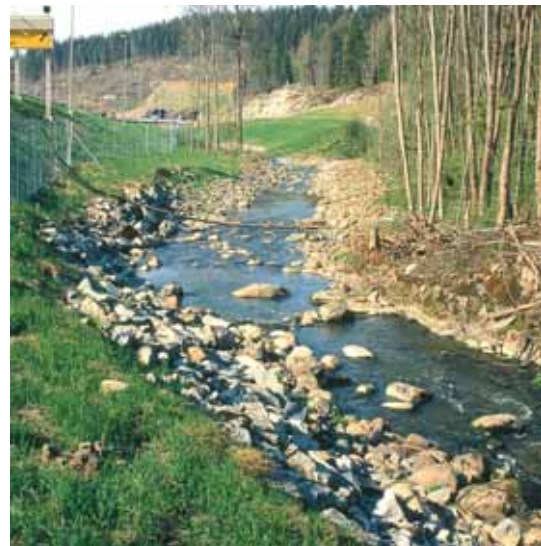
Figur 6-33: Eksempel på kompensierende tiltak fra Årungselsva. Det øverste bildet viser anlegging av nytt bekkeløp, mens det nederste viser det ferdige nye bekkeløpet. (Begge foto: B. Luell)
