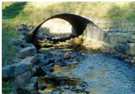
Figur 5-64: Kulvert laget av en bue av korrugert stål. Elvebunnen er her beholdt urørt. (Foto: A. Bruks)
