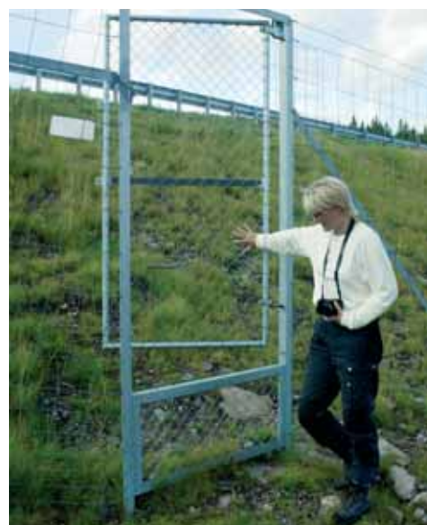
Figur 6-15: Porter bør slå innover mot vegen og være selvlukkende. Det kan være nødvendig å ta hensyn til at portene også skal kunne brukes i perioder med mye snø. Her fra rv 35. (Foto: B. Luell)
