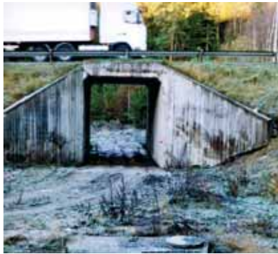
Figur 5-36: Landbrukskulvert under E6 i Ski kommune som pga liten bredde er dårlig tilpasset hjortevilt, selv om den ligger i et område med elgtrekk. Landbrukskulverter er som regel 3-4 meter brede. (Foto: V. Meland)
