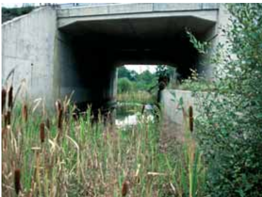
Figur 5-46: Kulvert med hovedfunksjon å lede vann i et våtmarksområde. Reposeet på høyre side gjør den også egnet som faunapasasje for små og mellomstore dyr. Frankrike. (Foto: H. Bekker)
