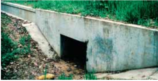
Figur 5-74: Rektangulær kulvert for amfibier i Tyskland med innebygde ledeanordninger. (Foto: J. Niederstrasser)
