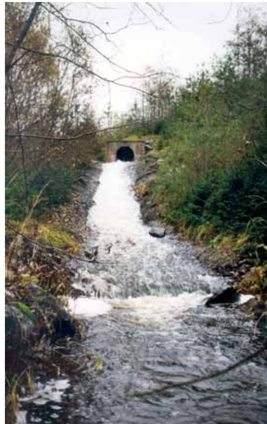
Figur 5-66: Stort fall ned fra kulverten i et kunstig utsprengt bekkeløp gjør det vanskelig for fisken å komme opp til denne kulverten. (Foto: V. Meland)
