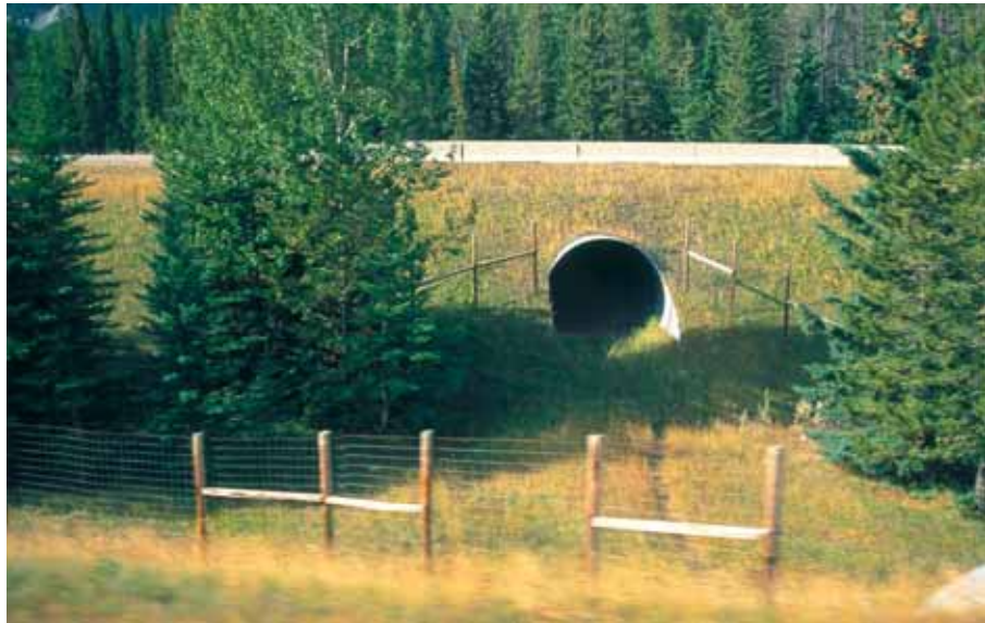
Figur 5-41: Kulvert i korrugert stål i Banff, Canada. På tross av størrelsen brukes den hyppig av "elk" (hjort). 4-feltsvegen går her i to separate vegbaner, slik at lengden på kulvertene blir redusert. (Foto: Bjørn Luell)
