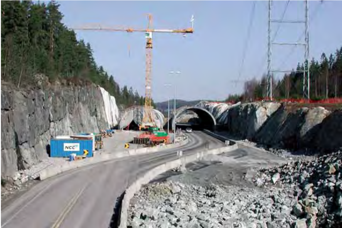
Utvidelse fra 2- til 4-felt krever andre typer vilttiltak. Viltsluser erstattes med faunaovergang på E6 i Ski. (Foto: B. Iuell)
