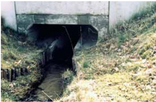
Figur 5-52: To prefabrikerte kulverter i Nederland med passasjer på sidene som brukes av små dyr. (Foto: G. Veenbaas og H. Bekker).
