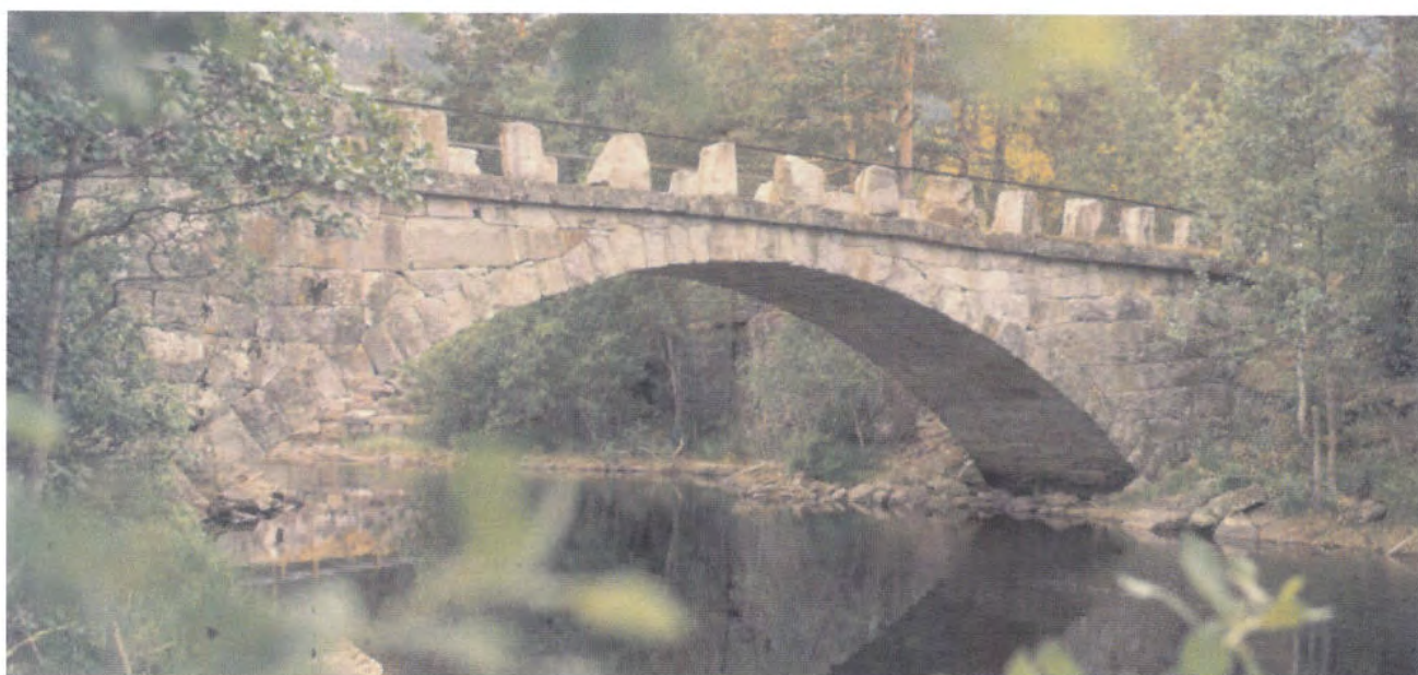
Sandvatnet bru, Tinn i Telemark, bygget 1896. Tørrmuring med hogget stein. Foto: Jan A. Martinsen
