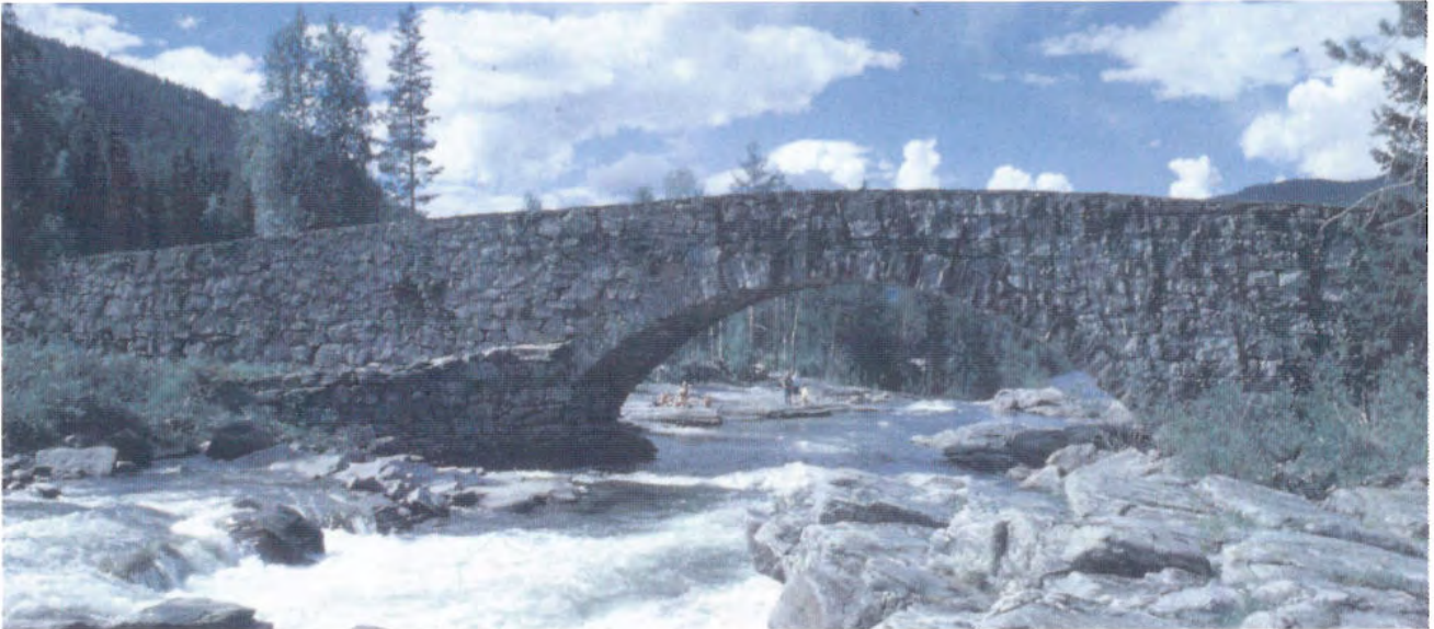
Lunde bru på Den Bergenske Kongeveg i Etnedal i Oppland, med spennvidde 20 meter. Bygget 1827-29. Brua er stadig trafikkert og er Norges lengste ett-spenns hvelv i tørrmur. Fredet. Foto: Rolf H Gulbrandsen
