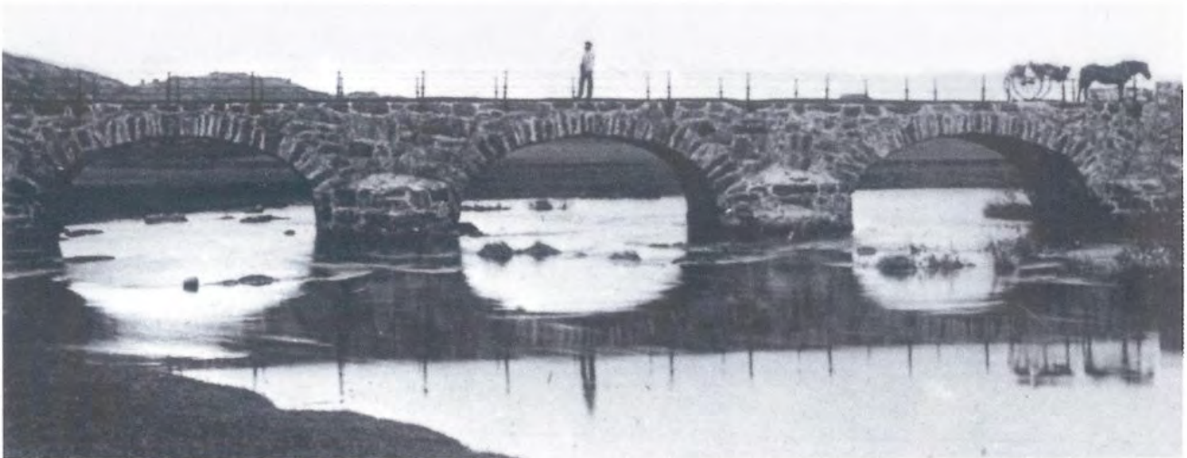
Hølland bru på den vestlandske hovedvei i Ogne, Stavanger amt, med lengde 33 meter. Bygget i 1843. Brua ble opprinnelig tørrmurt med tilpasset stein, men ble sementert i fugene i 1901 og 1919. Foto: Norsk vegmuseum
