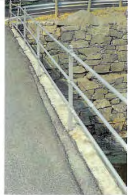
Figur 12.3. Steinhvelvsbru i Sønedeled, Aust-Agder. Flere lag med reasfaltering uten nedfresing ligger som langsgående ujevne kanter. Kjørebanelen har vokst seg høyere enn bruas opprinnelige kant. Asfaltkantenes ujevne linjer står i sterk kontrast til steinbyggernes presise tilpasninger. Foto: Ulf Haraldsen.
