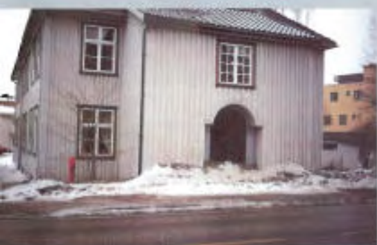
Figur 12.1. Holmestrand museum i Vestfold. Snøen fra riksvegen brøytes opp mot husveggen. Panelet, døren og portalen blir holdt fuktig i milde perioder, og faren for råteskader er stor. Portalen i bygningen er fredet. Foto: Inge Lindblom.
