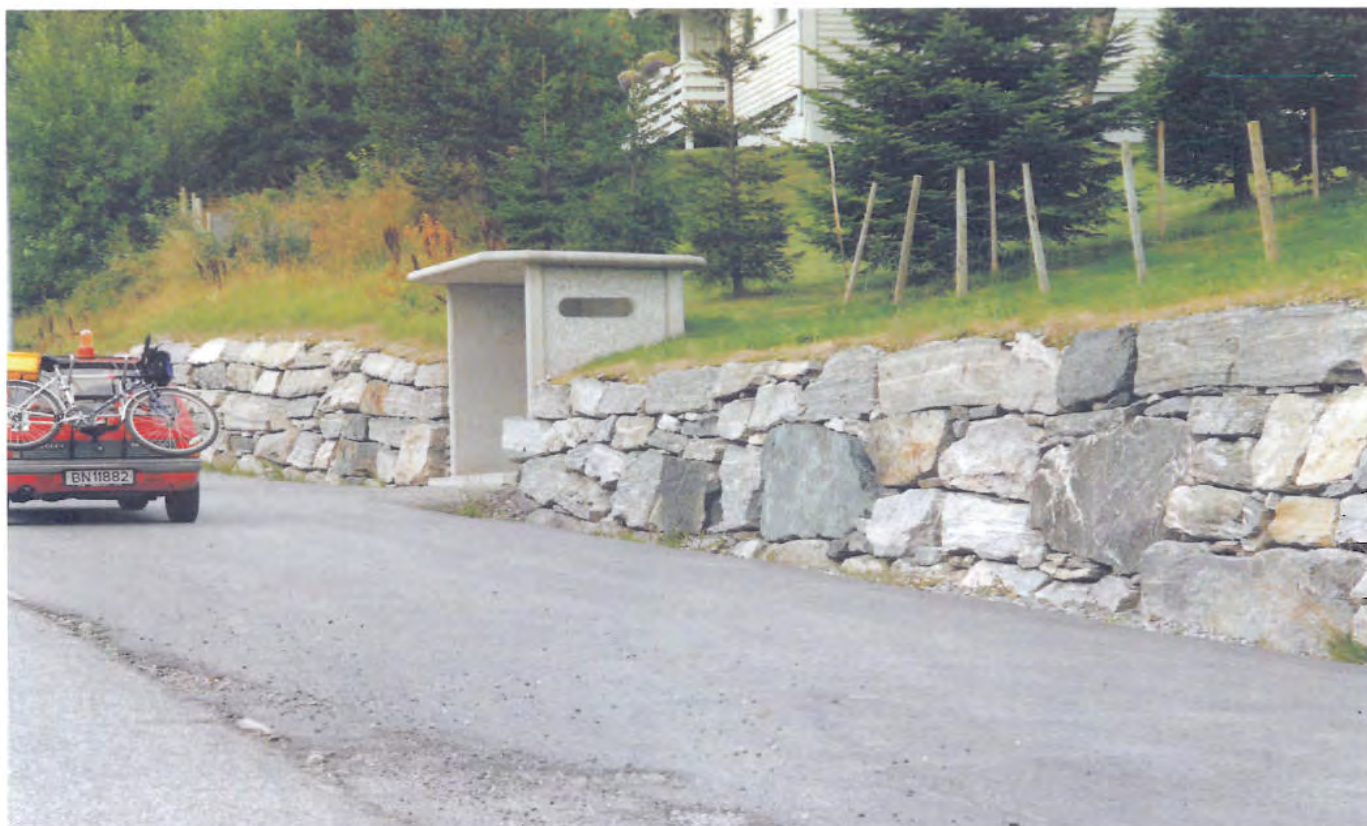
Fig. 9: Uheldig blanding av betongkonstruksjon og tørrmur. Det er viktig å tenkja heilskap når ein kompletterer anlegg.
