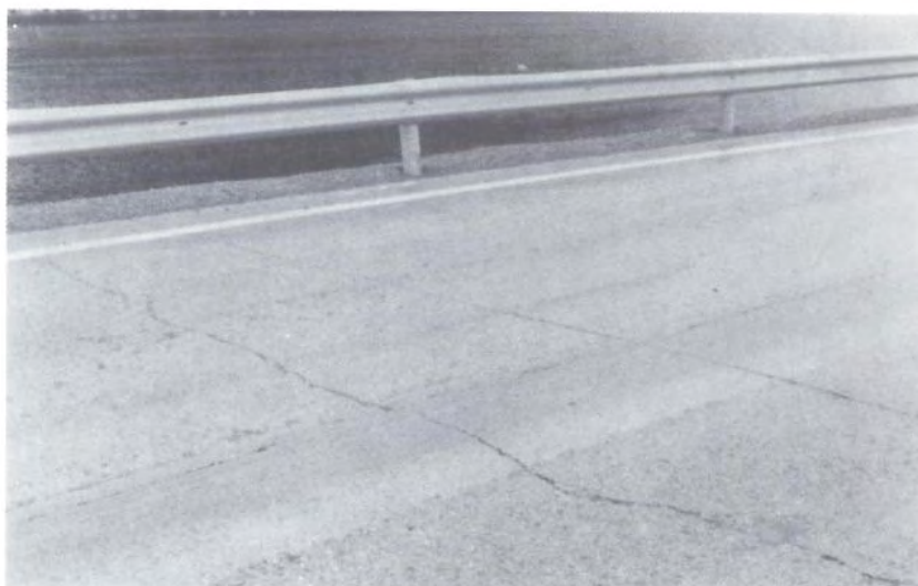
Figur 11.10 Sprekk ved siden av fugen
