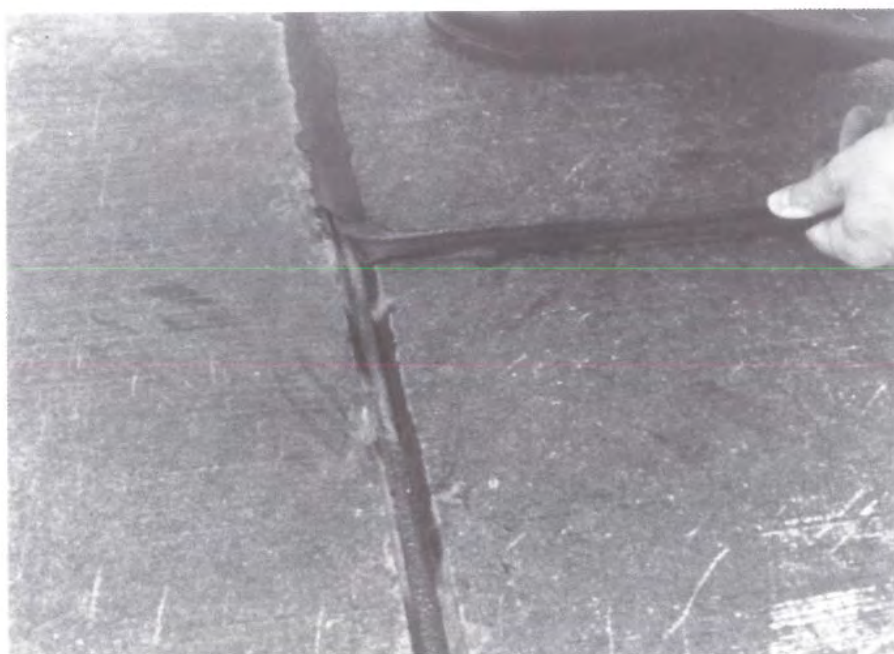
Figur 11.8 Hefibrudd mellom fugemasse og betong
