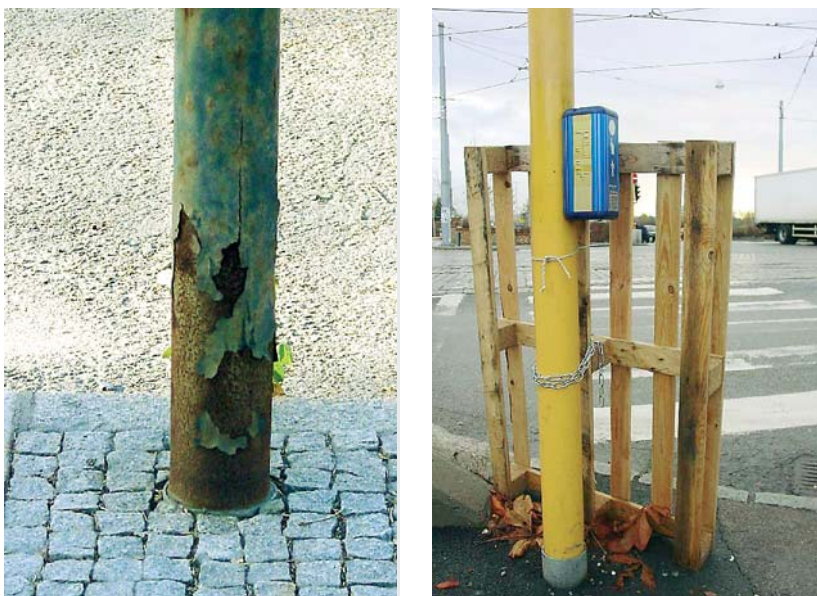
Figur 4-10: Rustskader bør utbedres og reklame bør fjernes.
