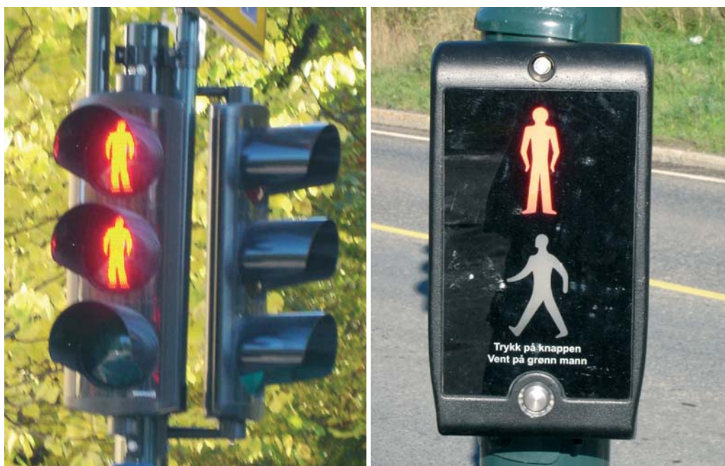
Figur 2-78: Ordinært lyshode for fotgjengergrupper (til venstre) og lyshode / trykknapp i PUFFIN-anlegg (til høyre).
