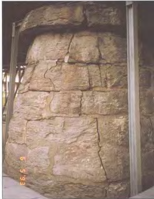
Figur 6.4-4 Sprekker i stein
