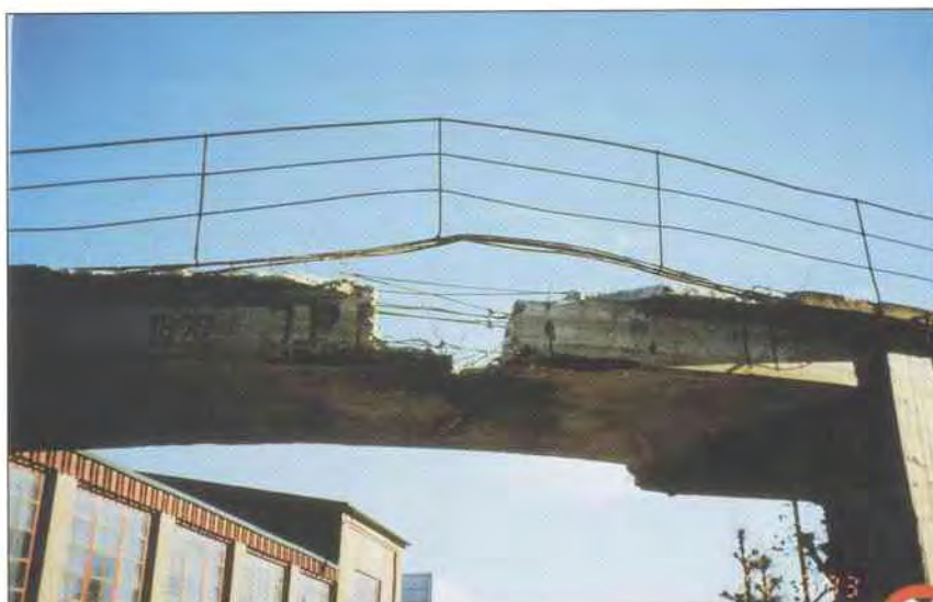
Figur 5.6-4 Brudd pga. 71 Påkjørsel
