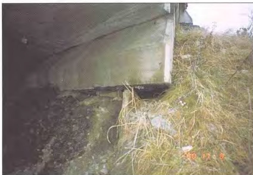
Figur 6.4-1 Erosjon av fylling
