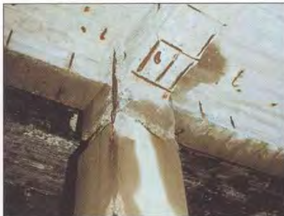
Figur 6.4-2 Armeringskorrosjon og avskalling
