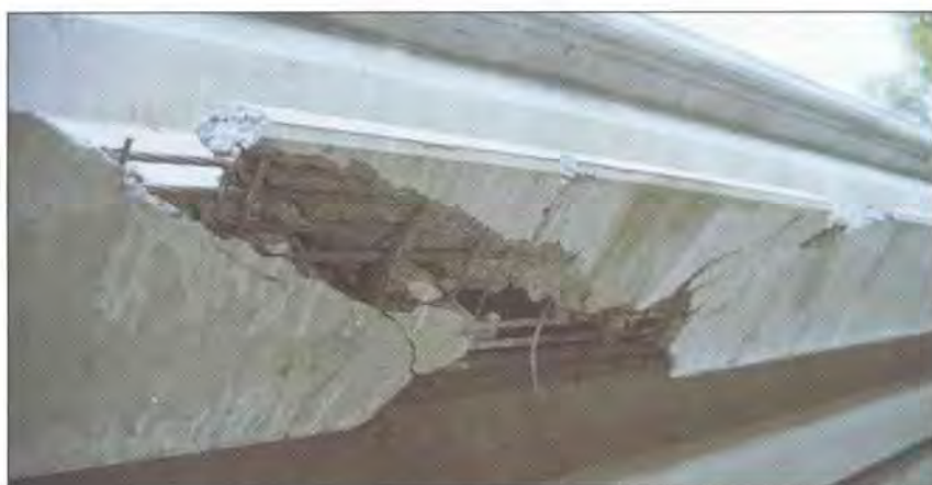
Figur 5.3-1 Skade med konsekvens for bæreevnen
