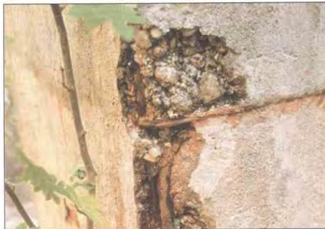
Figur 5.6-2 Armeringskorrosjon pga. 32 Feilplassert armering og 34 Manglende bearbeiding.
