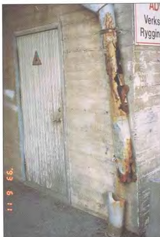
Figur 6.4-9 Korrosjon på avløp
