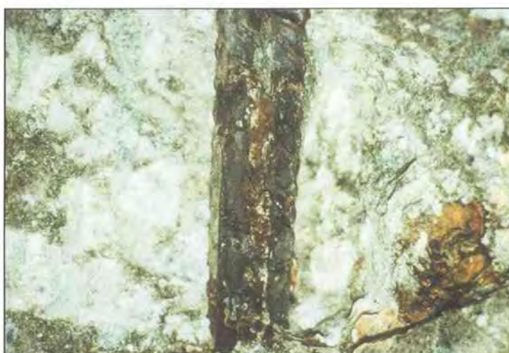
Figur 7.3-17 Eksempel på rustgrad E
