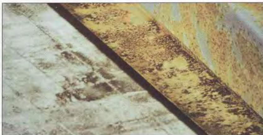
Figur 6.4-3 Malingskade og korrosjon
