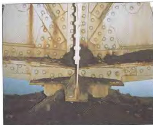
Figur 5.3-3 Skade med konsekvens for vedlikeholdskostnadene
