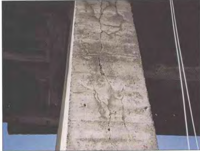
Figur 5.6-1 Riss/sprekker pga. 61 Alkalireaktivt tilslag
