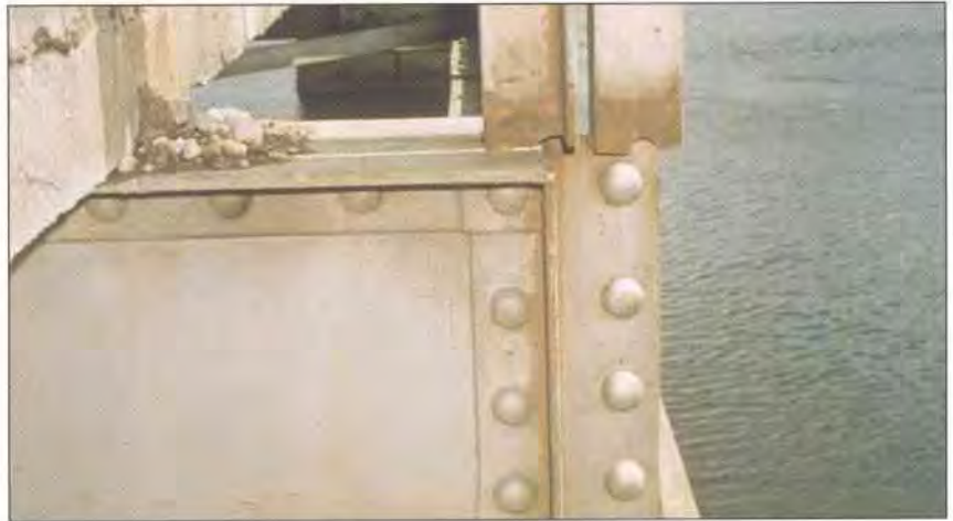
Figur 6.3-3 Brudd i stålprofil
