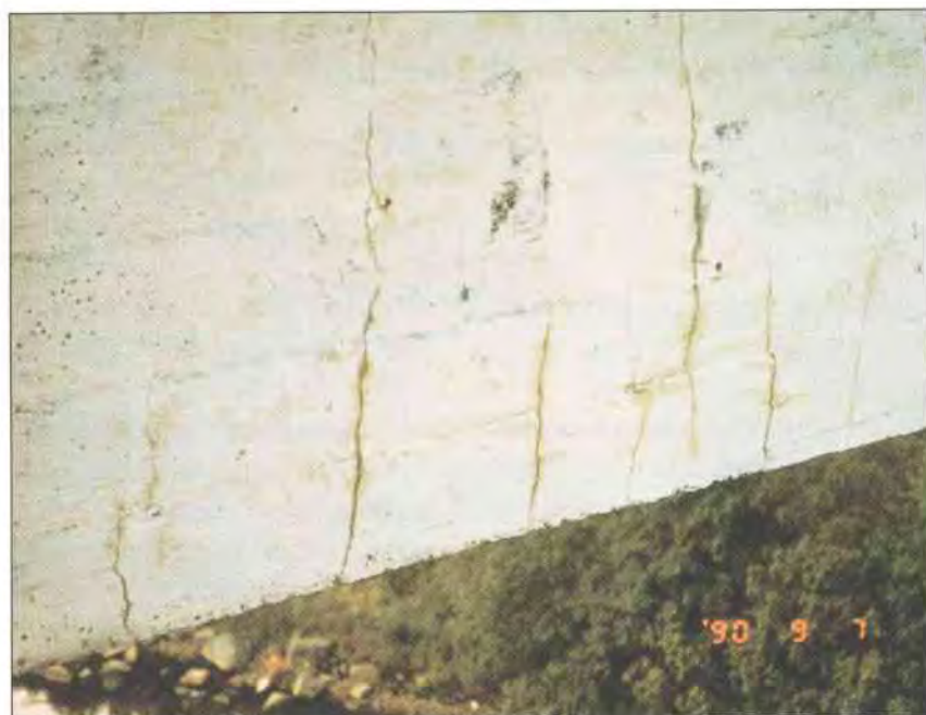
Figur 5.6-3 Riss/sprekker pga. 61 Belastning fra trafikk.
