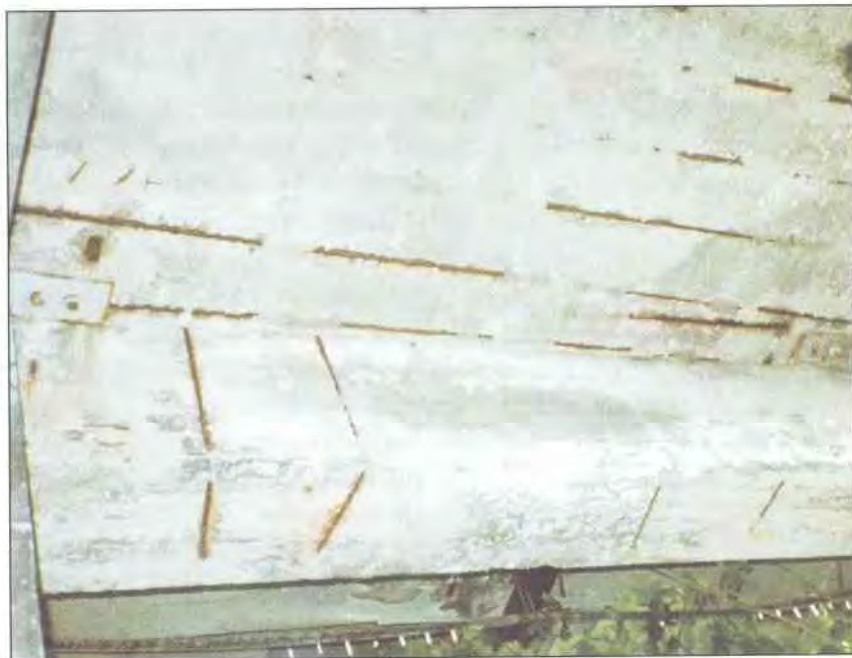
Figur 5.4-2 Liten/skadet overdekning, armeringskorrosjon og avskalling
