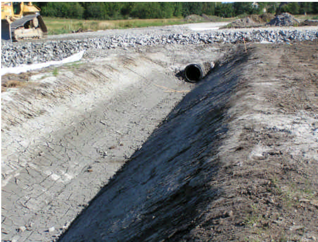
Plastrumma under väg med god fyllningshöjd och ett väl utfört avrinningsdike.
