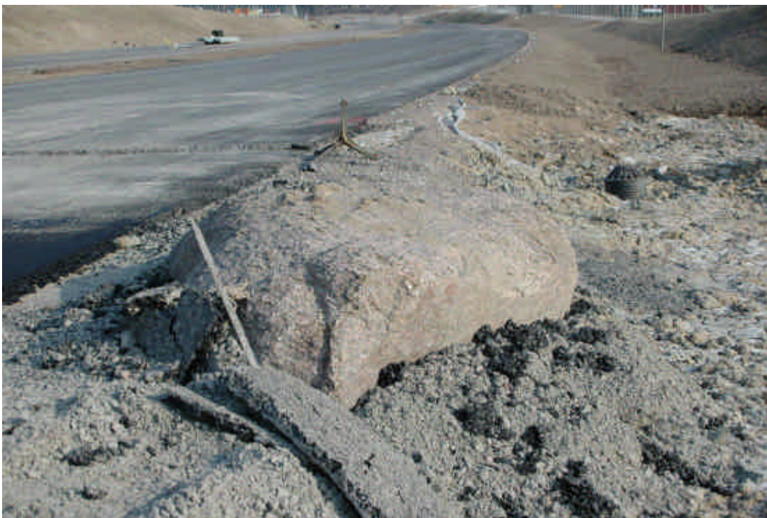
Ta bort i tid! Kvarlämnade block hindrar färdigställande av slänter och smutsar ned färdiga ytor.
