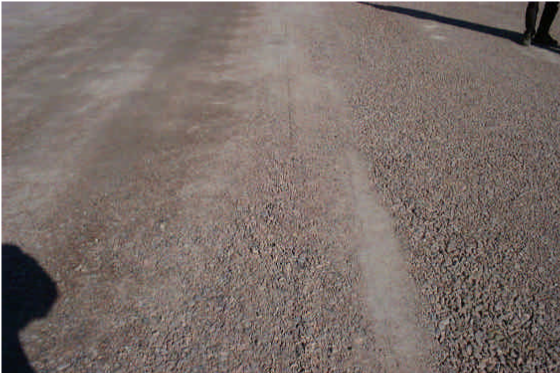
Separationer i bärlagret när det är utlagt. Detta kan ge framtida problem med bärighet, sprick- och spårbildning i asfalten.
