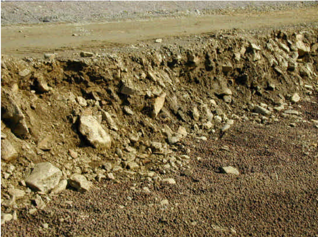
Tveksamt som förstärkningslager!
