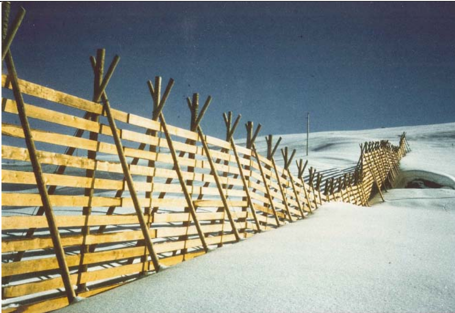
Figur 7-6 Snøskjermer er mest effektive når de står normalt på vindretningen og følger ryggen i terrenget. Ved kryssing av forsenkningen burde denne skjermen vært forhøyet. (Foto Harald Norem)
