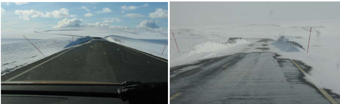
Figur 6-1 Foto fra Rv 890 Auster Tana-Gednje hvor vegen krysser Gednjevannet. Mot vannet er det montert rekkverk. På den øvrige strekningen av vegen er det minimalt med behov for brøyting under uvær, mens det på strekningen med rekkverk samler seg betydelige snømengder på vegen. (Foto Yngve Øverli)
