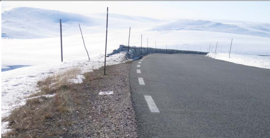
Figur 5-6 Fonn dannelse ved rekkverkssende. Fv 891 Gednje-Båtsfjord. (Foto Yngve Øverli)
