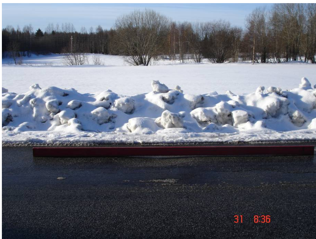
Figur 3-24: Teststrekning på Fv 544. Langsgående nedsenkning på 30 mm
