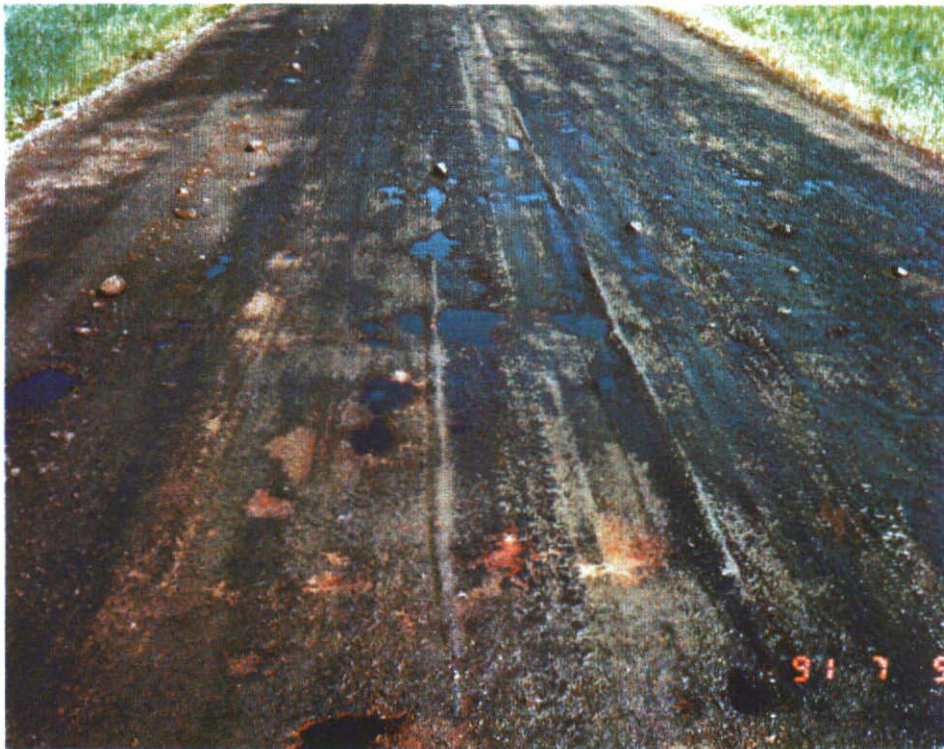
Dustex må ikke legges ut når det ventes regnvær.
