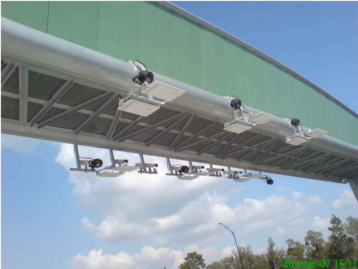
Antenner og kamera i en "multilane" bomstasjon
