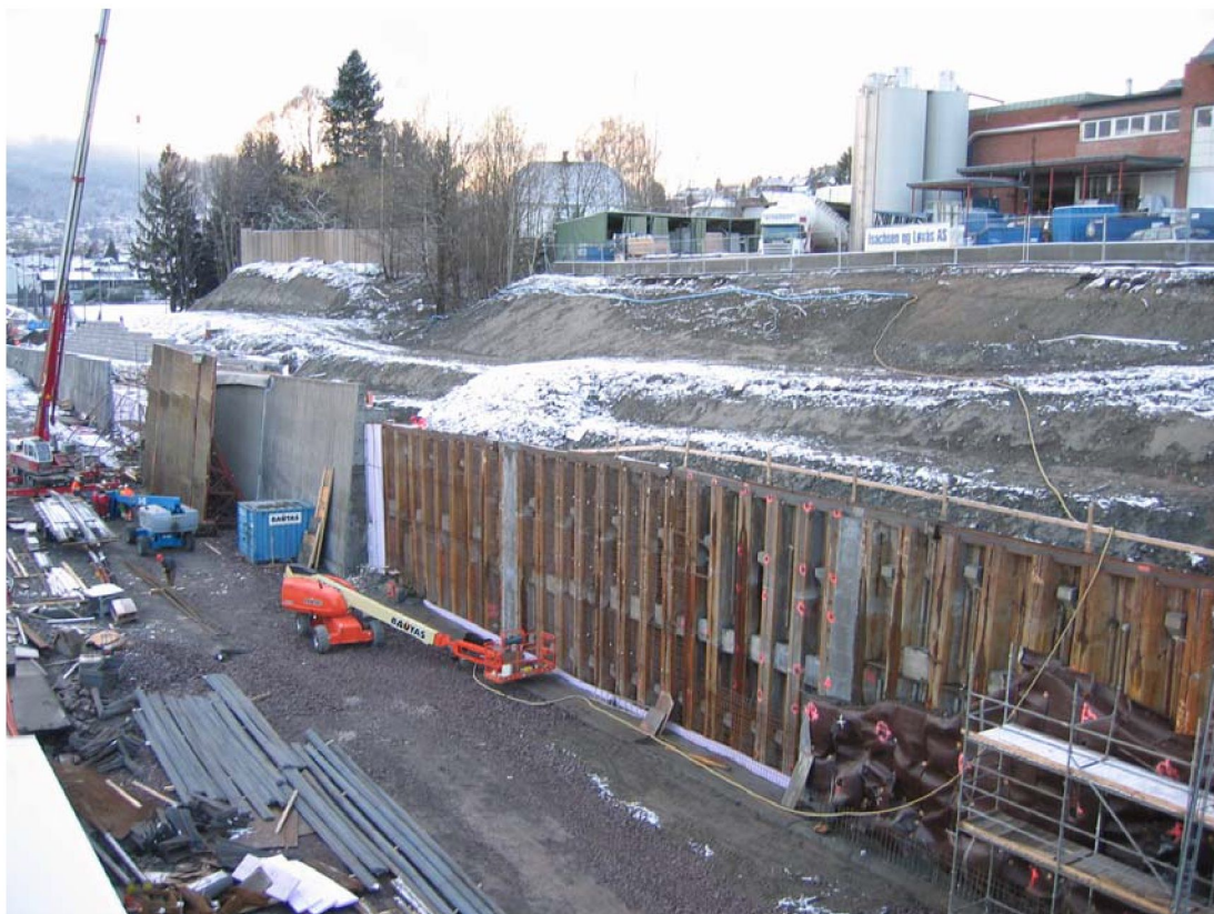
Figur 20 Oversikt over spunt 1 når alle stagen er montert og korrosjonsbeskyttet med betong
