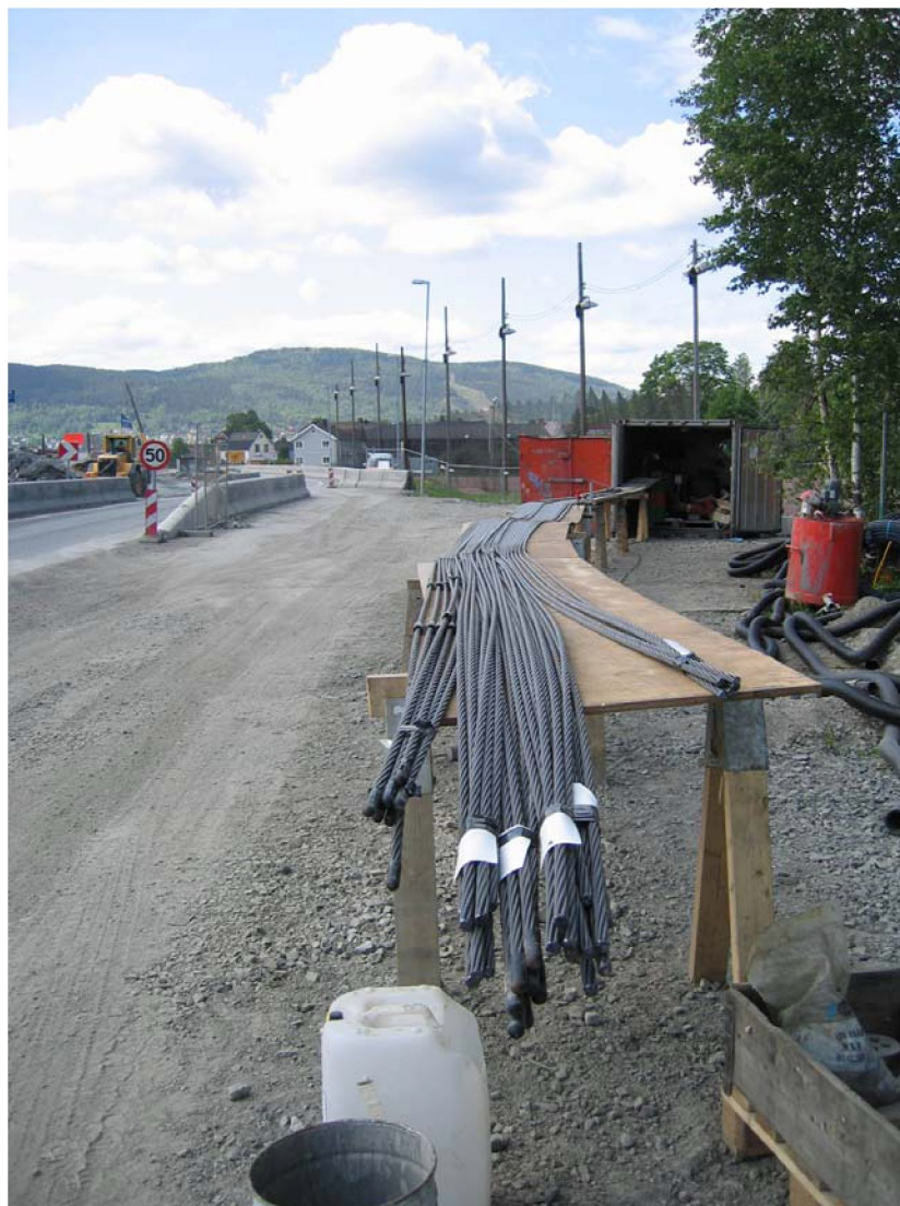
Figur 16 Spennstålkablene til stagene (lissene) ble kappet og fettet på stedet. Her ligger lissene på bordet klar for montering. De 5 lissene lengst til venstre av har blitt påmontert avstandsholdere av plast som under tvil ble akseptert av byggherren. Lissene ble trædd ett for ett ned i korrugert hylse. En bedre løsning er at alle lissene blir trædd samtidig med avstandsholdere som holder alle lissene sammen.
