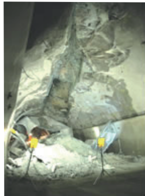
Bildet: Rasmateriale og betongrester fra vann og frostsikringen. Det er også kommet ned noen større blokker. Foto: A. Kveen
