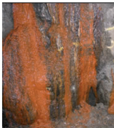
Bilde til venstre: Kombinert bakterie og sjøvassangrep under sjø.
