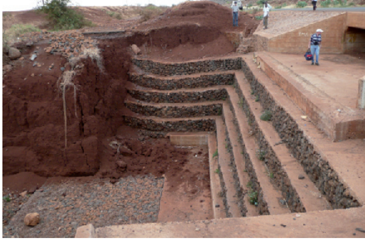
Erosjon ved kulvert
