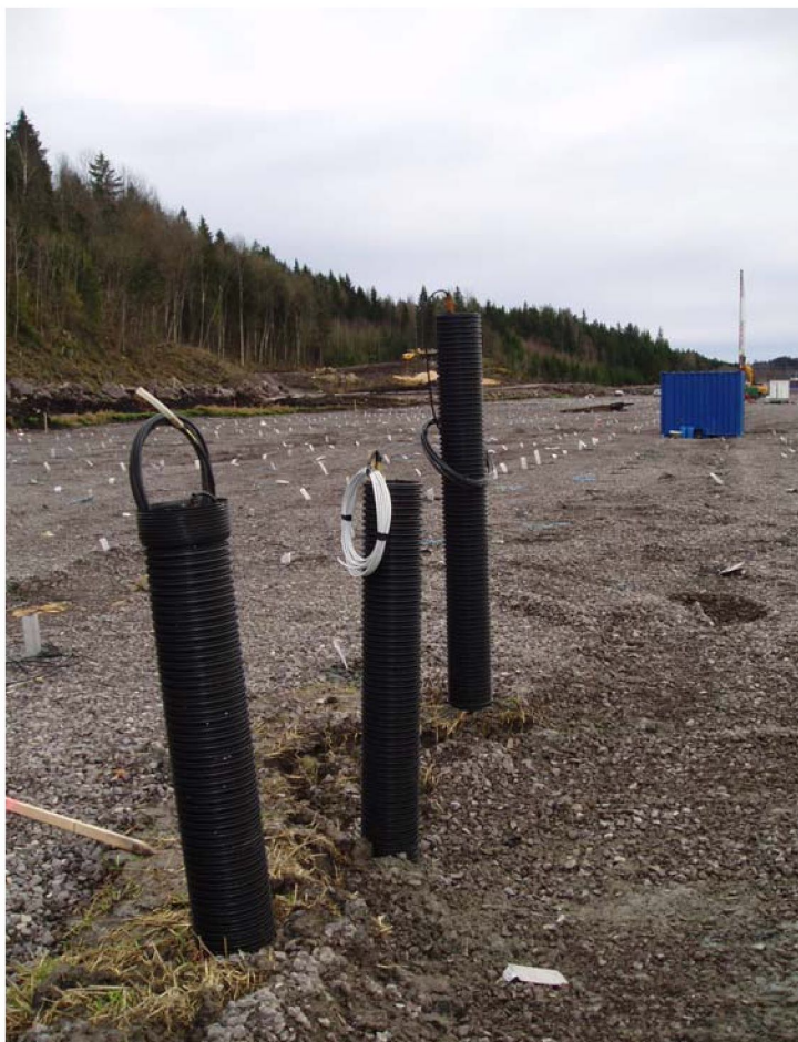
Bilde 7. Det ble brukt poretrykksmålere i forbindelse med kontroll av stabiliteten ved oppfyllingen
