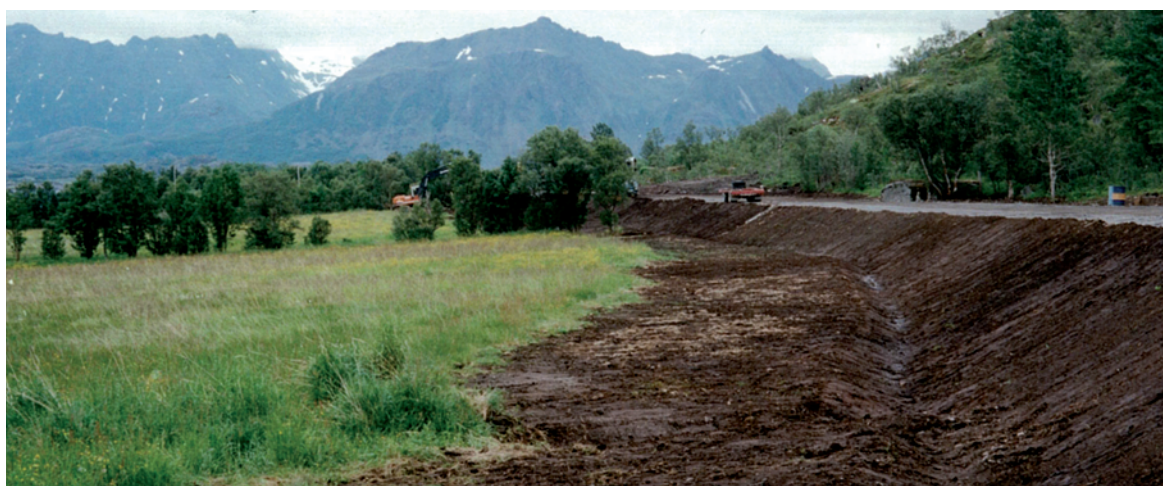
Figur 16: Dette bildet fra Lofast I viser hva som tradisjonelt sett har blitt oppfattet som godt maskinførerarbeid. Det var ikke dette byggherren etterspurte på Lofast II. Foto: Rosenfeld
