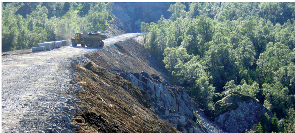
Figur 8: Bratte fyllinger må sikres med rekkverk. Foto: Eliassen
