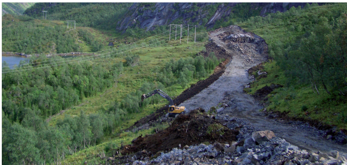
Figur 7: Det typiske normalprofilen i sidebratt terreng var å slake ut og avrunde inn mot stigende terreng, og ha bratt fylling på utsiden. Foto: Kongsbakk
