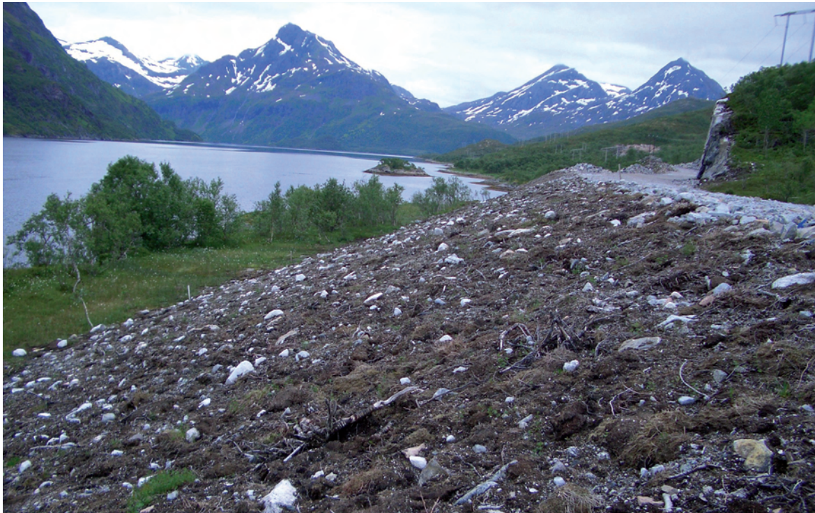
Figur 31: Enkelte strekninger langs Lofast II ble pusset over somrene etter at vegen var åpnet, fordi vegdistriktet mente utførelsen var blitt for røff. Foto: Kongsbakk
