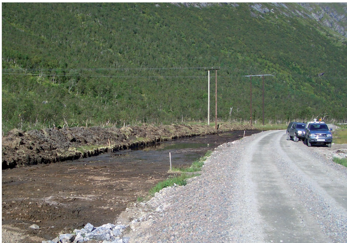
Figur 14: Anleggsvegen fulgte traseen for permanent veg. Den ble bygget rett på torvlaget ved bruk av armeringsprodukter og et tynt lag overdekning. På bildet er forbreddelsene for bygging av permanent veg i gang. Vekstmassene er skavet av. Torv av stor mektighet ble trauet ut og kjørt på mellomlager. Foto: Kongsbakk
