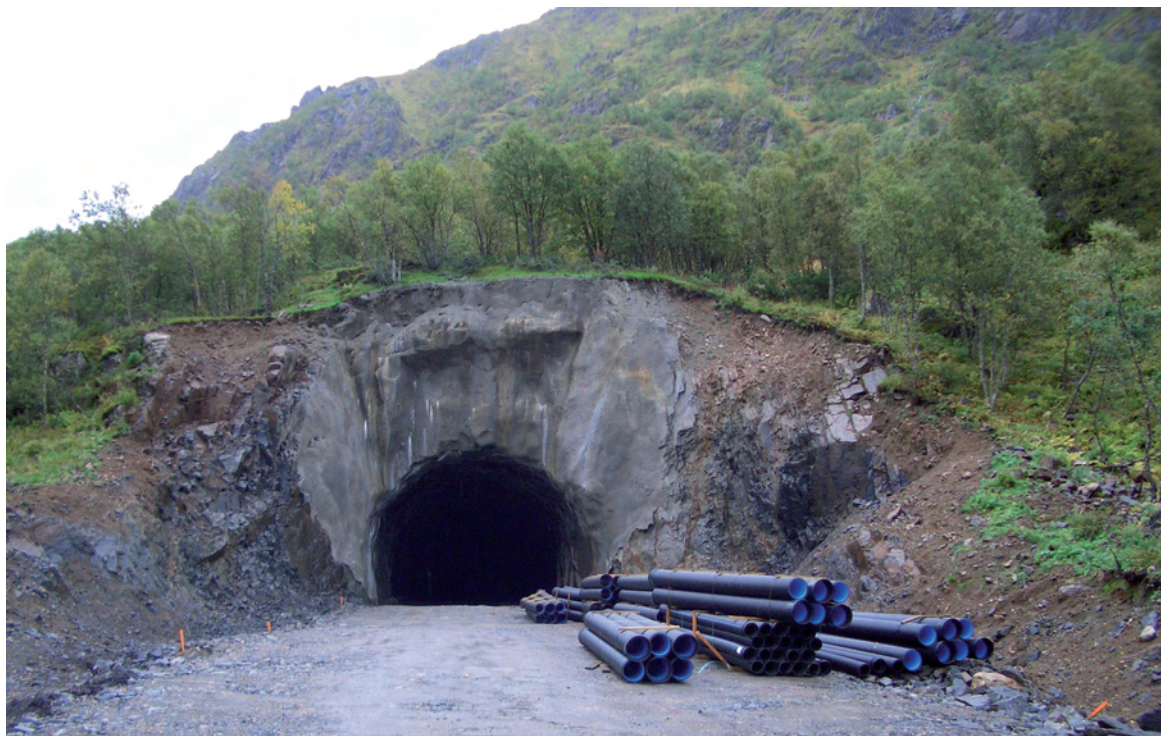
Figur 21: På steder som dette er det viktig at byggherren er våken. Det er som oftest bedre å ta noen meter mer i terrenget og få til ei stabil skrånning som kan revegeteres, enn å tviholde på inngrepsgrensa. Foto: Kongsbakk
