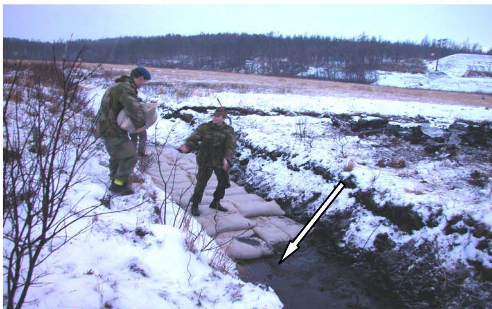
Figur 10-2. Eksempel på et gjennomstrømningsfilter som bygges opp av sekker i en tungmetallforurenset bekk. Sekkene er fylt med filtermateriale. Vannet ledes ut på overflaten, filtreres gjennom sekkene og renner renset ut i forkant av filteret (hvit pil). Sekkene kan tas opp når filtermaterialet er mettet. Bildet er fra Bardufoss i Troms.
