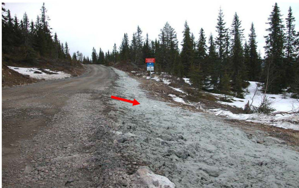
Figur 10-3. Eksempel på kontaktfilter. Det grå feltet langs utsiden av veien (merket med rød pil) er finknust olivin som er lagt ut i en 2 m bred streng. Filteret fanger opp og renser avrenningen fra tungmetallholdig bærelagsmateriale som er brukt i veikonstruksjonen. Bildet er fra Regionskytefelt Østlandet i Åmot kommune.
