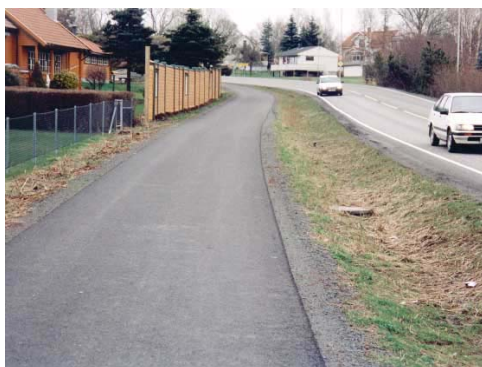
Figur 4.10 Boligområde eller landevei? Denne gangveien har for lav standard i forhold til omgivelsene. Anlegget er utformet som en nødtørftig gang- og sykkelvei med en åpen grøft mot kjørebanelen. Dette er et boligområde! Dette er stedets møteplass og felles område for gående, – dette er med andre ord stedets promenade. Her burde det vært en bred rabatt med trær mot kjørebanelen og selvfølgelig benker i viktige krysningspunkt.
