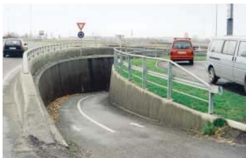
Figur 4.15 Tilbudet til fotgjengerne er en mørk og uoversiktlig sjakt under veganlegget.
