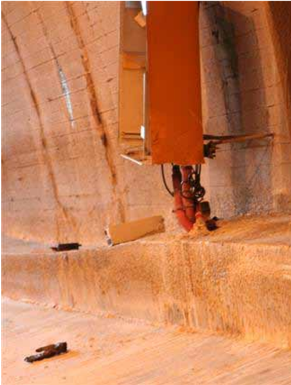
Påkjørt brannskap i tunnel
