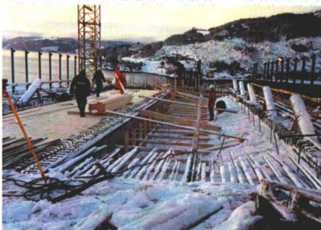
Fig. 2.8 Undergurt og midtvegg er støpt, og forskaling av kantdragere og dekke samt innmontering av forankringsrør pågår.
