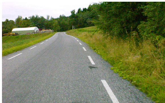
Fv166 høsten 2005 - etter tiltak
