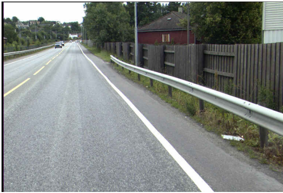
Sporlegging på rv 110 ved Fredrikstad i 2001. ÅDT 23000. Dekket ble lagt i 1993 og fornyet i 2002
