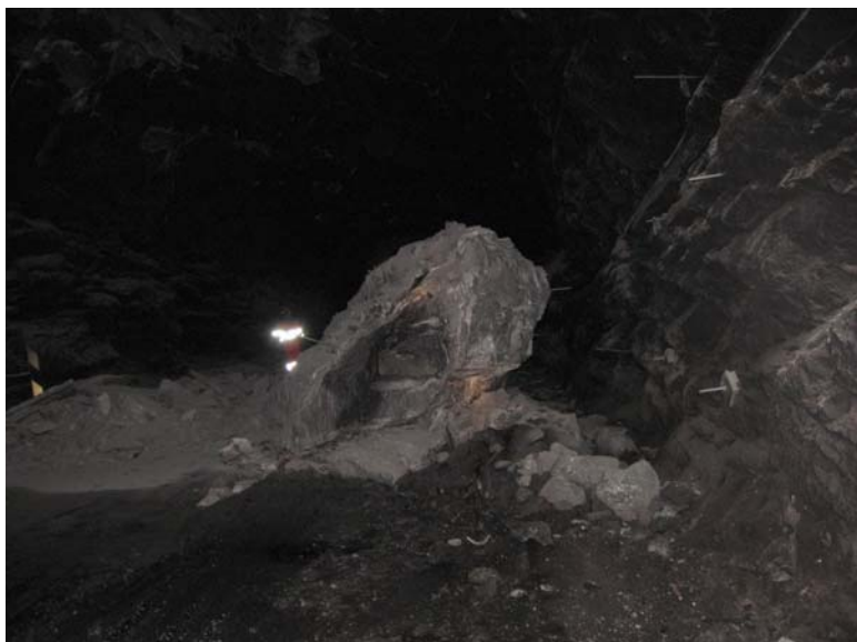
Figur 21 Blokknedfall oppstrøms brannstedet
