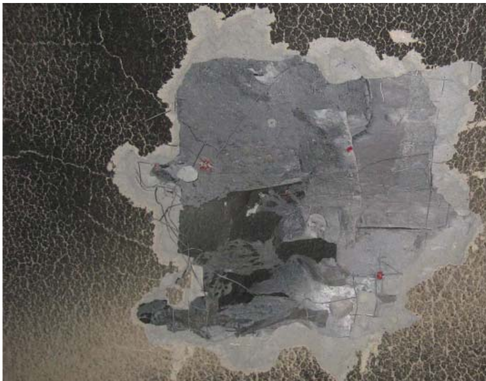
Figur 19 Pigget hull på om lag 1 m 2 . I nederste område ses smeltet isolasjon.
