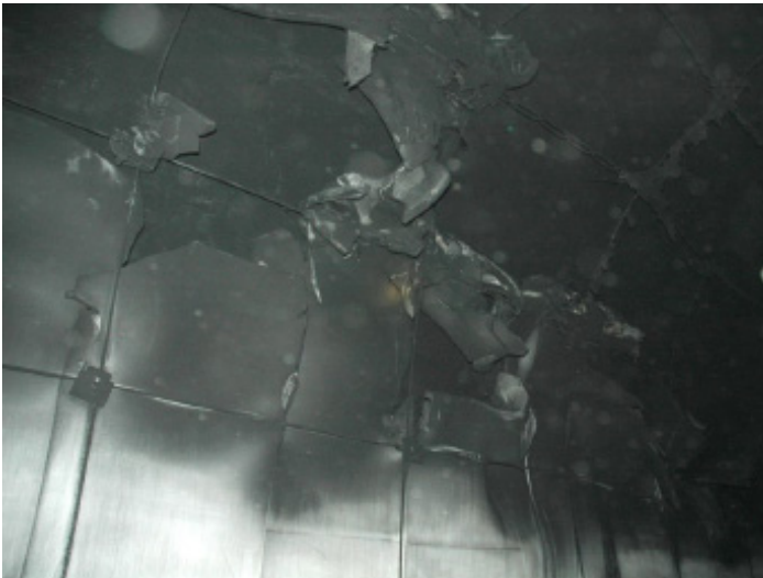
Figur 16 Smeltet ubeskyttet pE skum 60 m oppstrøms brannen
