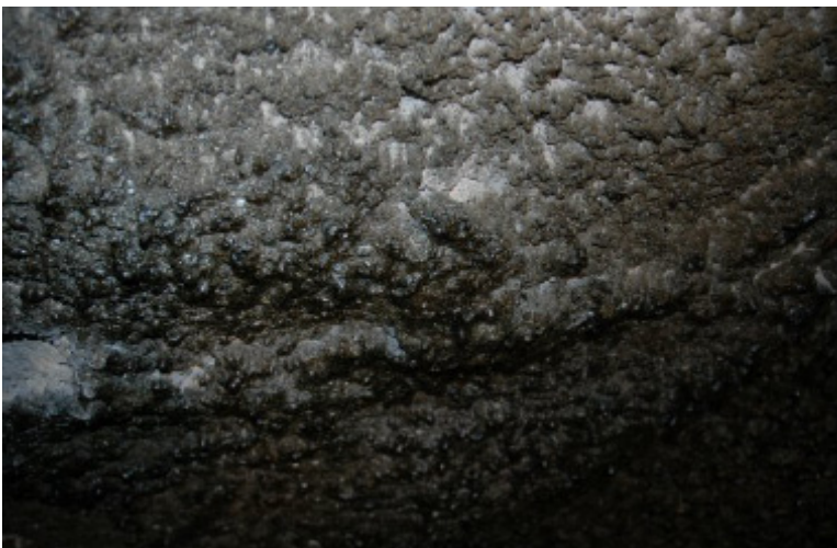
Figur 20 Smeltet/glassert sprøytebetong etter brannpåkjenning
