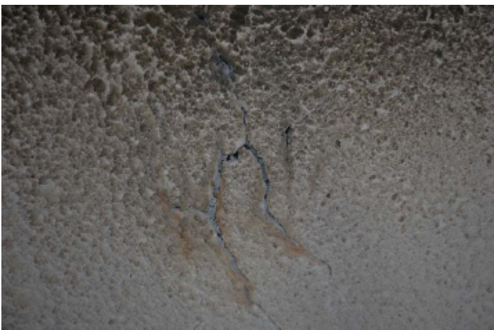
Figur 17 Sprekkdannelse etter brannpåkjenning
