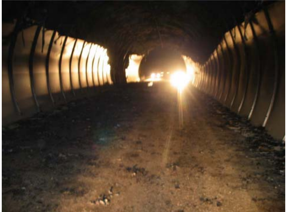
Figur 7. Tunnelhvelvet etter branntesten sett fra nedstrøms side.
