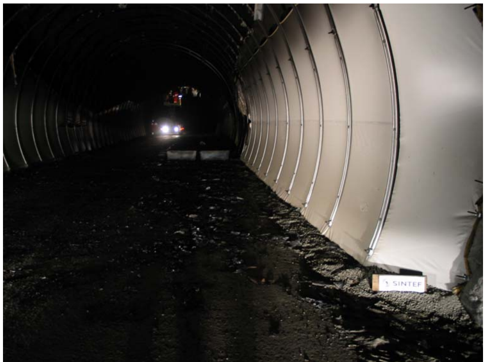
Figur 8. Duken er intakt i veggen fra vegbanenivå fra oppstrøms kant av brannkilden.
