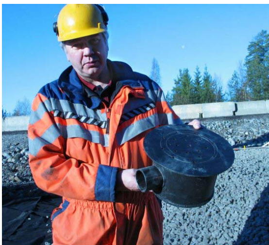
Bilde 4: Tor Helge Johansen, Statens vegvesen, viser frem sluket som ligger i membranen og tar imot vannet
