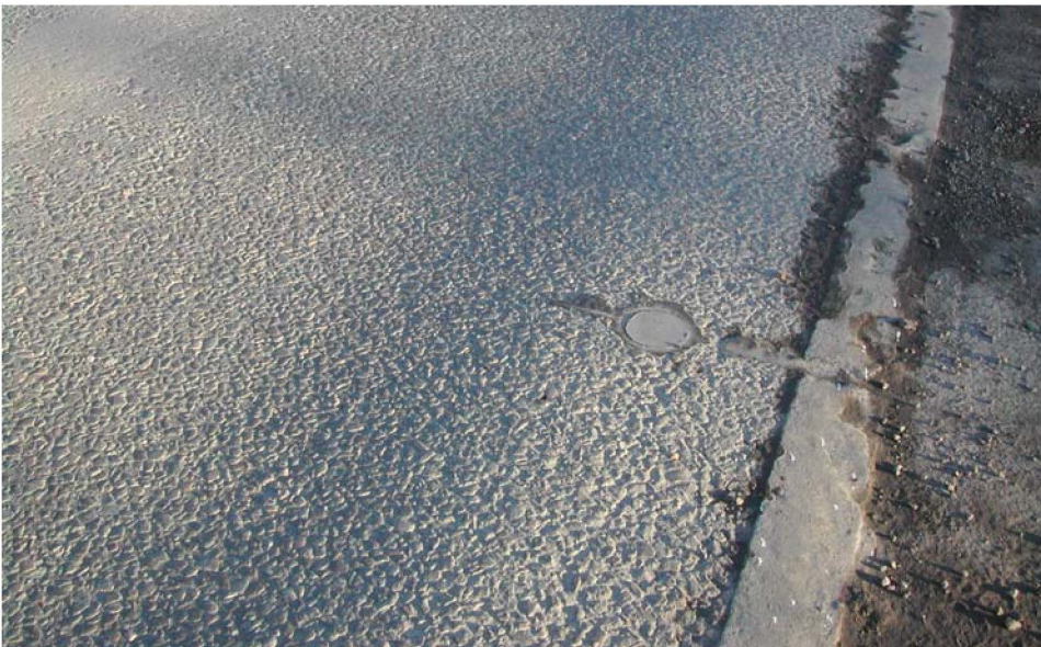
Figur 3.14: Vegbanesensor i Sørkedalsveien (Rv 168)
