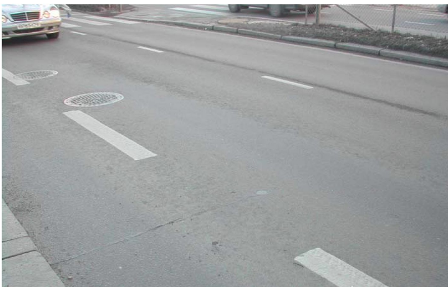
Figur 3.12: Vegbanesensor i Kirkeveien (Rv 161)
