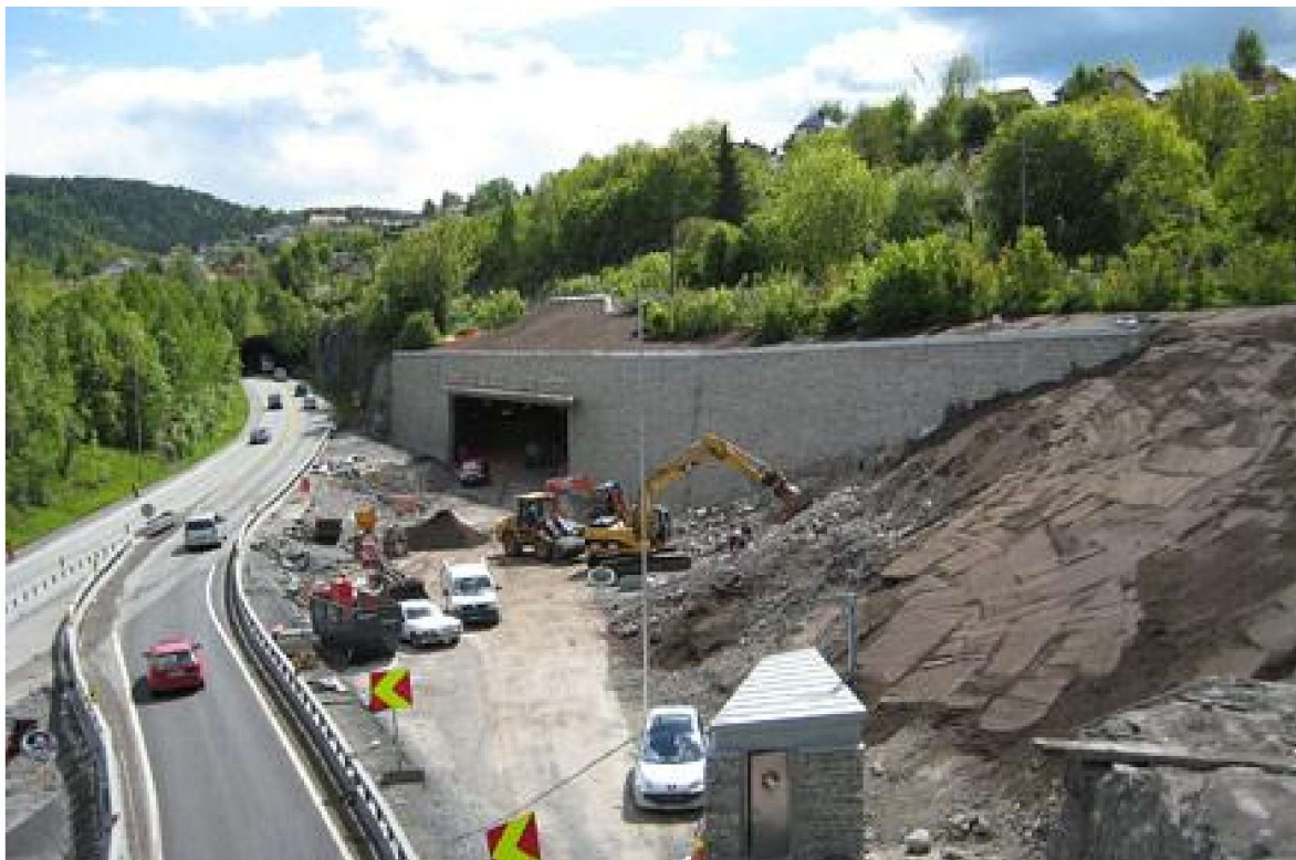
Figur 2. Arbeid med tunnelportalen på Frydenhaug. Arbeidet med å legge ut matjord og terrengforming har startet opp.
