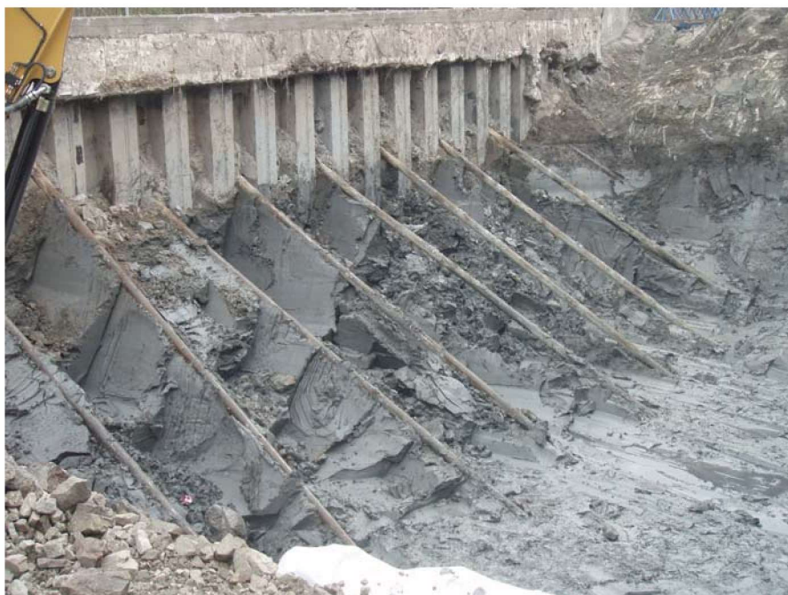
Figur 24. Avgraving bak eksisterende spunt mot E18. Vi ser frigraving av stagene i bløt leire.
