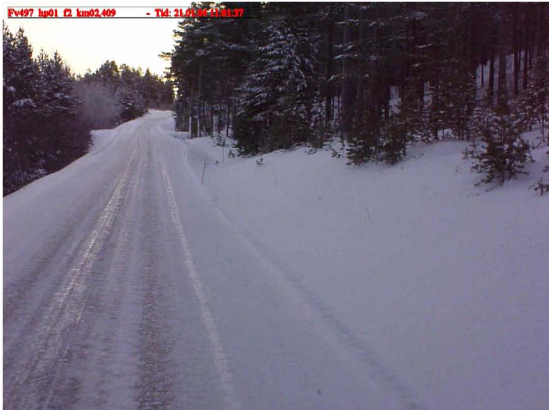
Figur 2.16: Situasjonen før strøing på Fv 497, strekning 3
