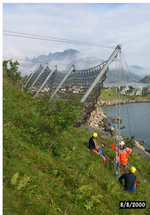
Bilde 1 Rasfanggjerde Ev 10 Reine, Nordland
