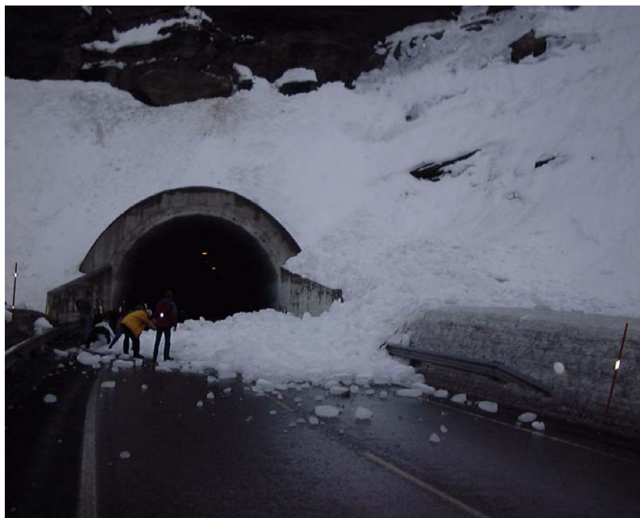
Bilde 4: _____ 80% av tunnelene registrert har rasproblem i tunnelmunningene. Her E6 Middagsfjell tunnel i Nordland.
