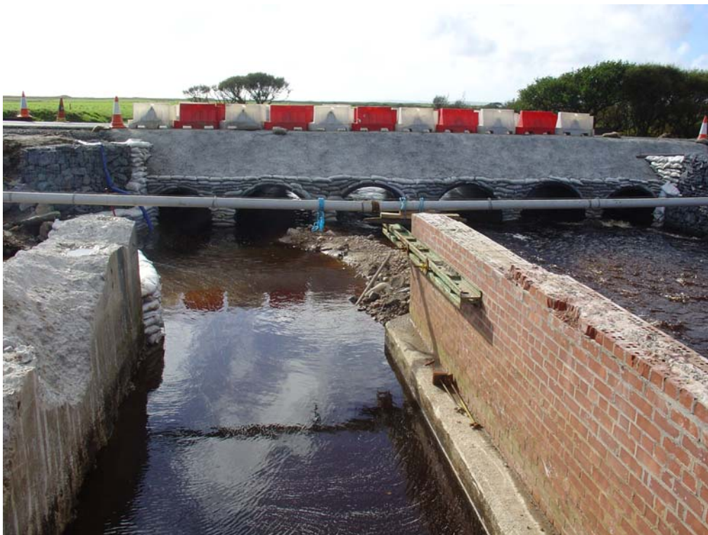
Smart løsning på omkjøring rundt broen som skulle repareres. Brofundamentene i forgrunnen var helt uarmerte (betong til venstre), og til og med ett bygget i tegl (til høyre). Dette er nok noe man ikke finner så ofte i det norske vegnettet. Spesielt med tanke på at det er tungtrafikk som trafikkerer denne strekningen ifm Whisky destilleriene.
