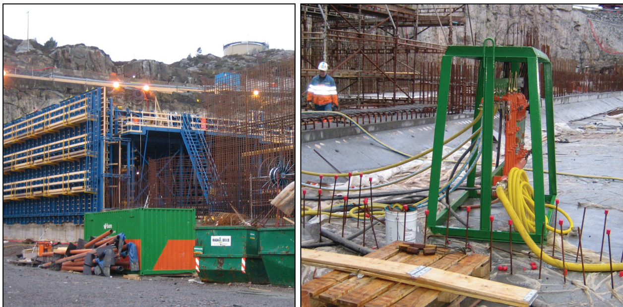
Figur 8. Kjøleaggregat (grønn container) og manifold for fordeling av kjølevann
