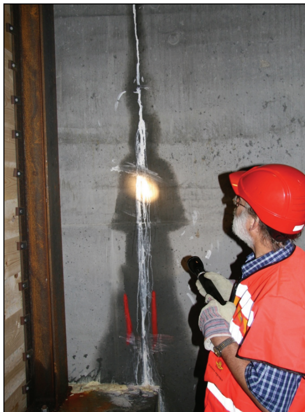
Figur 9. Reidar Kompen studerer lekkasje i riss i tunnelement 5 etter ankomst Bjørvika. Segment uten kjøling.
