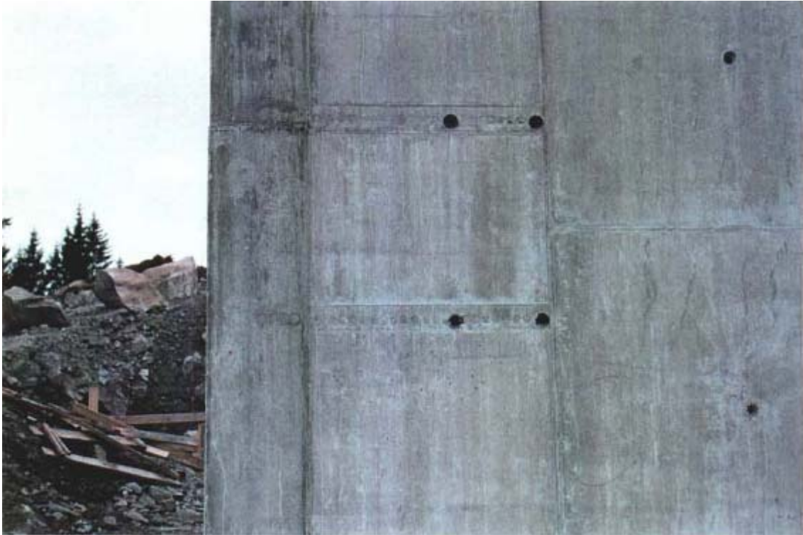
Fig. 6. Detalj ved hjørne. Bemerk mørkere overflate hvor forskalingen hadde stålhud. Bemerk også noen vannrender.
