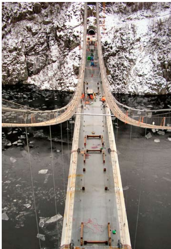
E39 Flekkefjord – Lyngdal. Feda bru under bygging. Foto: Veidekke ASA/Ole R. Paulsen.
