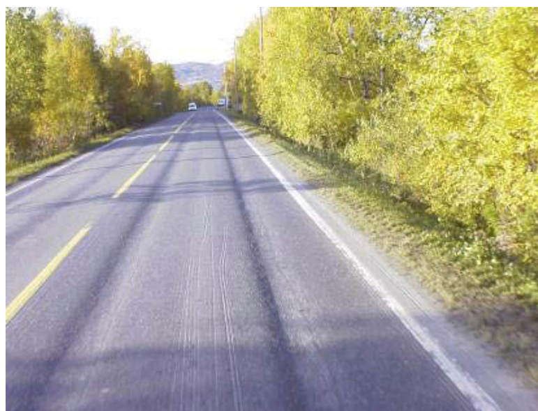
Figur 8: Bilde tatt ved ulykkesstedet (km 3,150) i personbilens kjørefelt 18. sept. 2008 (foto: vidkonbilde fra Statens vegvesen).
