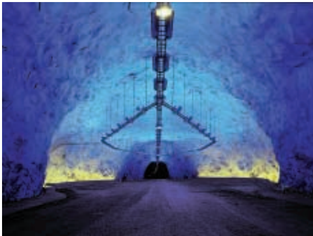
Figur 10 Belysnings- interiør bergrom, Lærdalstunnelen.
