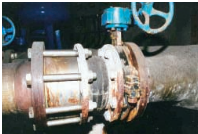
Figur 22 Korrosjon på pumperør og flenser.
