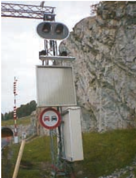
Figur 14 Styring og overvåking også utenfor tunnel.
