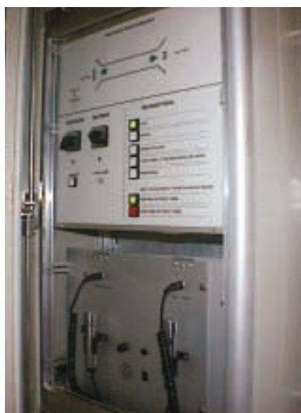
Figur 12 Elektrotavle i tunnel.
