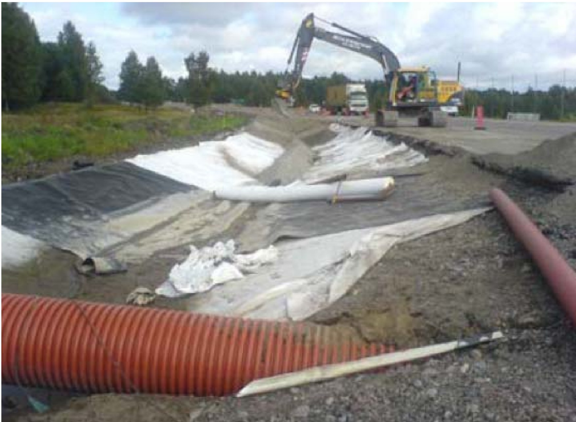
Figur 26. Viser legging av tette grøfter for beskyttelse av grunnvann for vannforsyning i Sverige. Denne løsningen er planlagt brukt på sårbar strekning på Rv80 i Gävle (fra Vägverket 2009).
