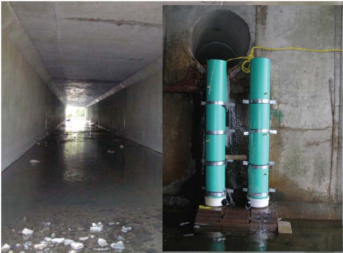
Figur 11. Viser en målestasjon for kontinuerlige målinger av ledningsevne i tilknytning til en bekkekulvert og et mindre overvannsrør som munner ut i denne kulverten (fra Perera et al. 2009).
