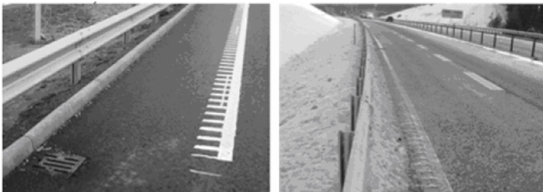
Figur 17: Oppsamling av saltholdig avrenning fra veibanen gjennom kantrenner og sluk på E4 ved Begraåsen i Sverige for beskyttelse av grunnvannsressurs brukt til drikkevann (Lundmark, 2008).
