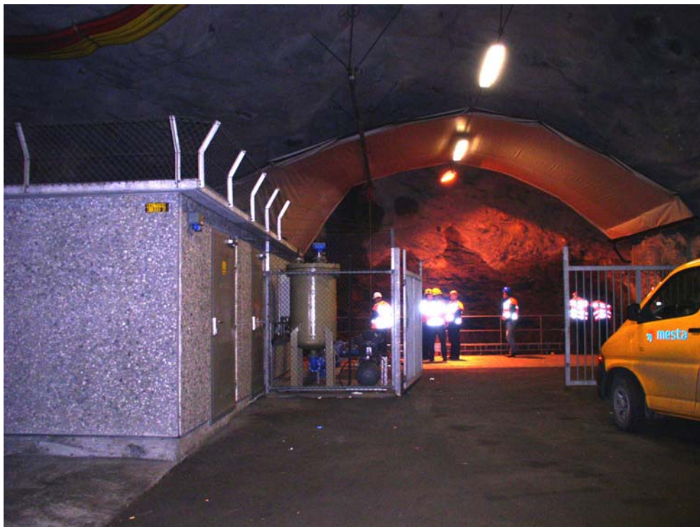
Øvre pumpe-stasjon, teknisk rom til venstre.
