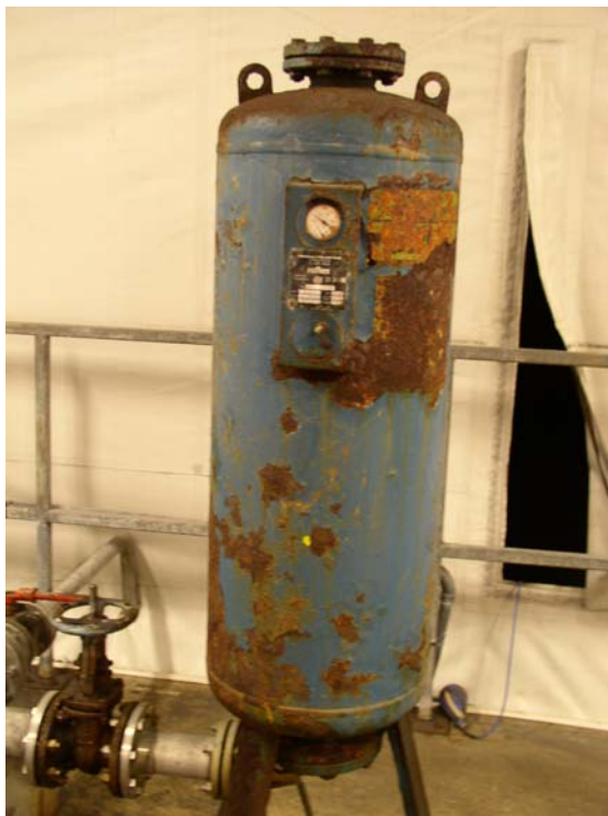
Sterkt korrodert vindkjel i Nappstraumtunnelen
