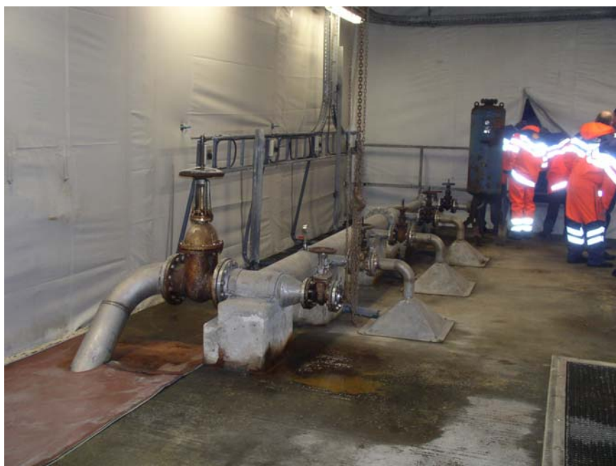
Pumpedekk og pumpearrangement i Nappstraumtunnelen. Legg merke til at helle pumperummet er kledd med duk for å hindre drypp og korrosjon.
