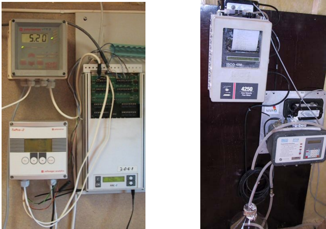
Figur 17. Måleinstrumenter i bu ved bassenget for kontinuerlig registrering av konduktivitet, turbiditet, temperatur og vannføring samt innhenting av vannføringsproporsjonale vannprøver.
