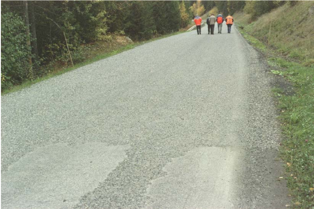
Figur 9. Fv 358-01. Dekkeskade pga. bindemiddelavrenning etter regnvær like etter utlegging (10.10.02)
