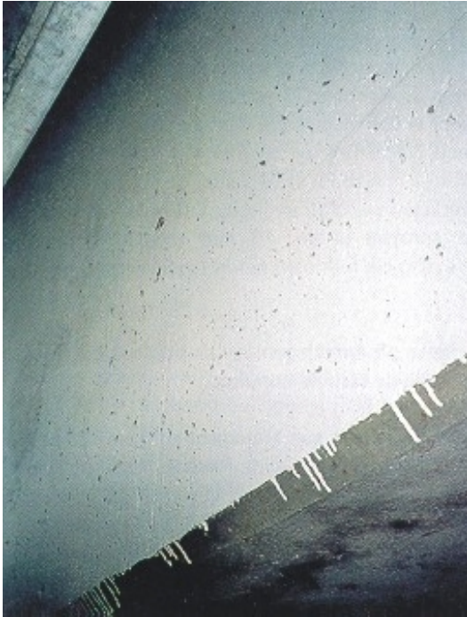
Foto 5.3.1: Mange synlige porer i kassevegg etter behandling med Protect Lasur.
