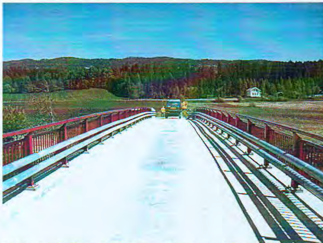
Bilde 20 : Brurekkverket har 2 førings Skinner på hver side. Kjøredekket består av et betongslutlag, støpt monolittisk med bruoverbygningen.
