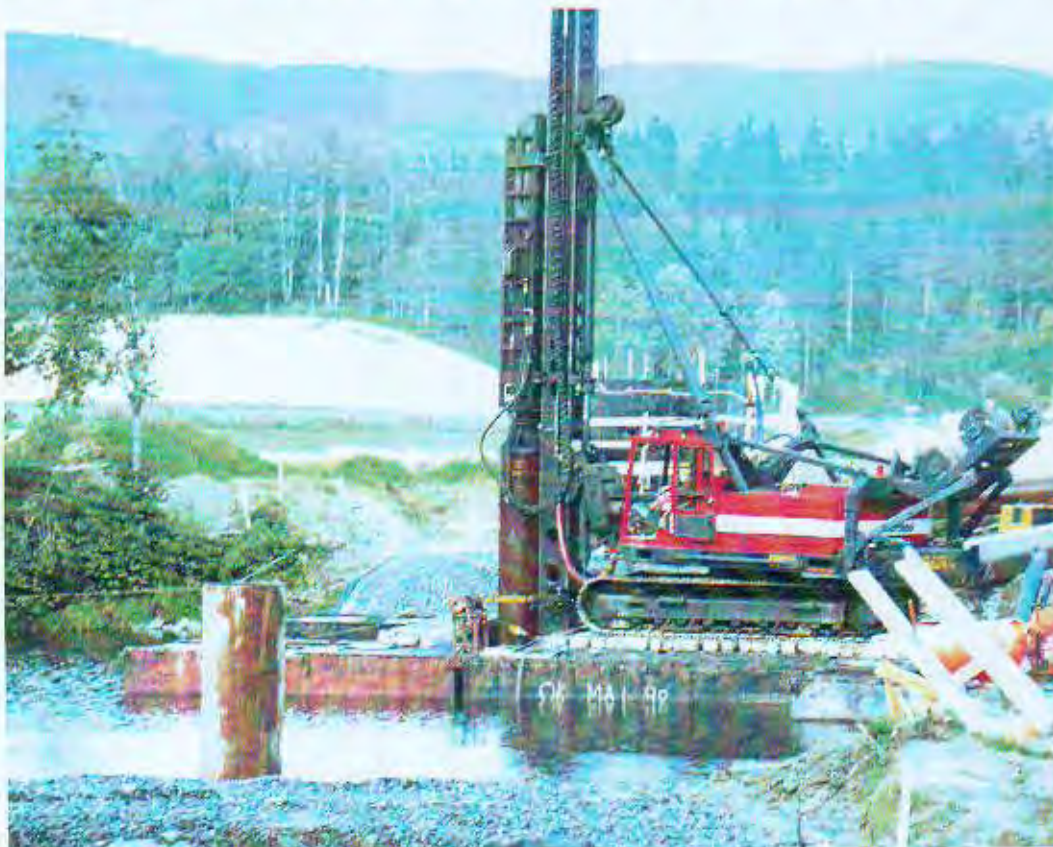
Bilde 22 : Ramming av stålrørspel i elva ( begge pelene kollapset under ramming ).
