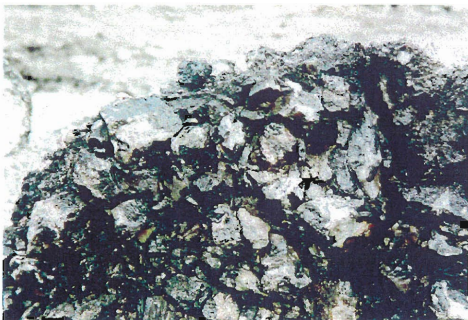
Foto 3. Undersidan av de uppbrutna asfaltflaken bestod av indränkt makadam som på vissa ställen avgav en stark lukt av tjära.
